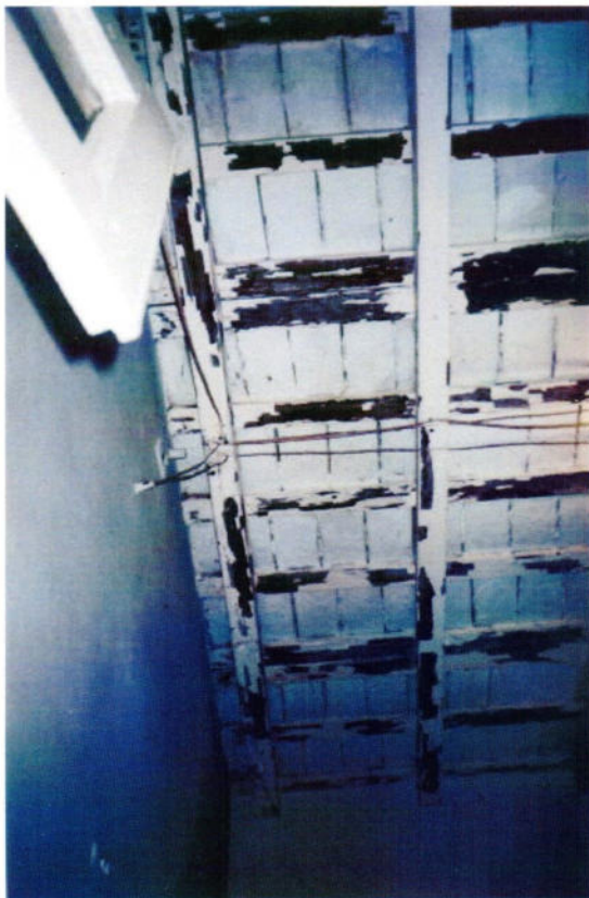
22. Detalhe da tijoleira sob a telha de zinco (Levantamento Cadastral, 2003)
