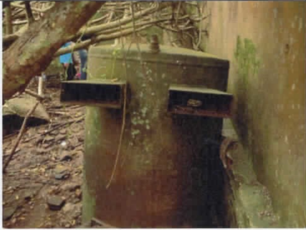
Parte da caldeira metálica
