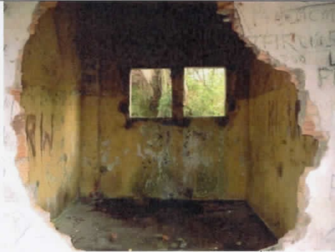
Parede parcialmente demolida
