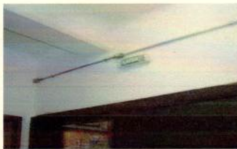
iluminação de emergência
