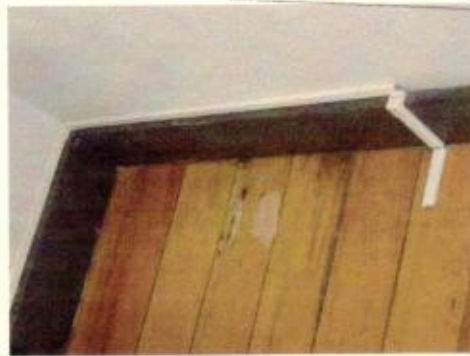
Cupins no pav. e canaletas que conduzem a rede lógica
