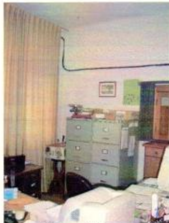
Redes elétrica e lógica passando
