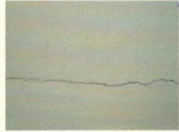
Rachaduras na alvenaria
