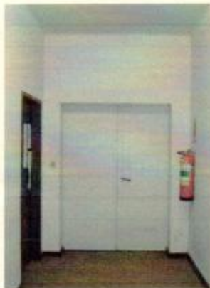
extintor de pó químico
