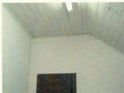
Caimento do forro – cupins
