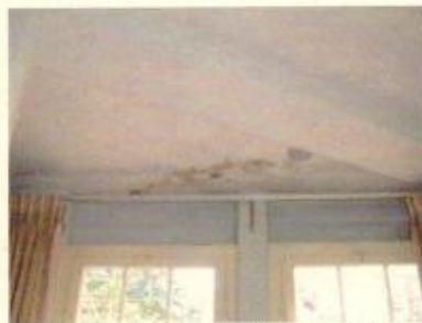
Infiltração no forro do auditório
