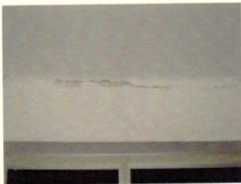
Rachaduras no reboco acima da porta do corredor
