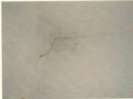
Manchas, rachaduras e descascamentos
