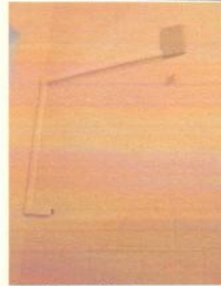
Instalação elétrica aparente
