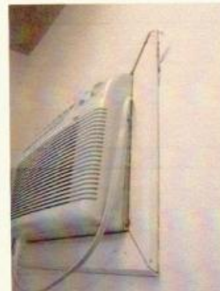
Aparelho de ar-condicionado
