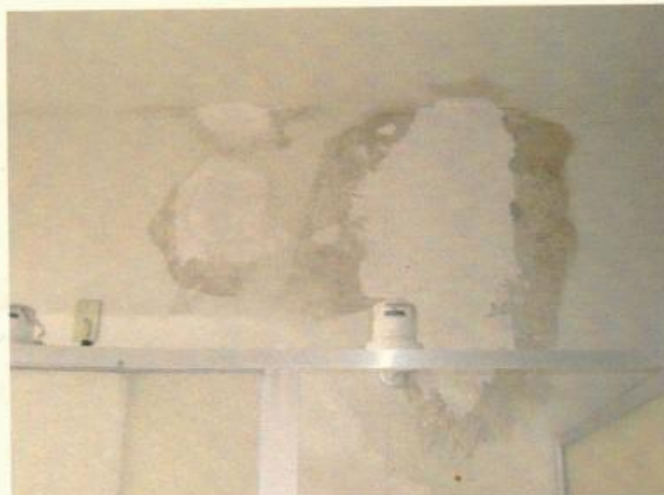
Parede do banheiro com problemas de umidade e infiltração
