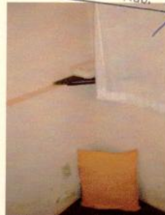
Bolor nas paredes da Capela que fazem divisa c/ exterior
