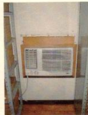
Aparelho de ar-condicion.
