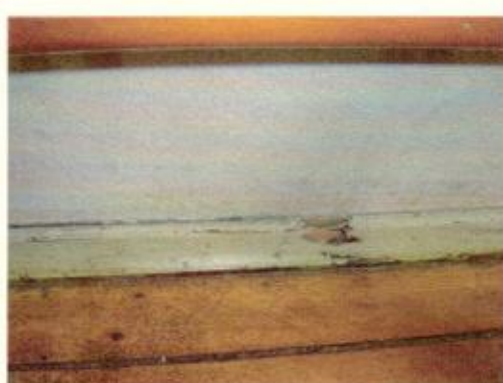
Sala 320 danos nos rodapés
