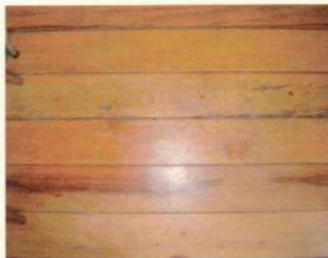
Assoalho desgastado pela ação do tempo
