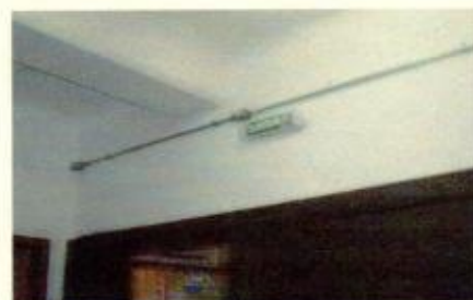
Iluminação de emergência
