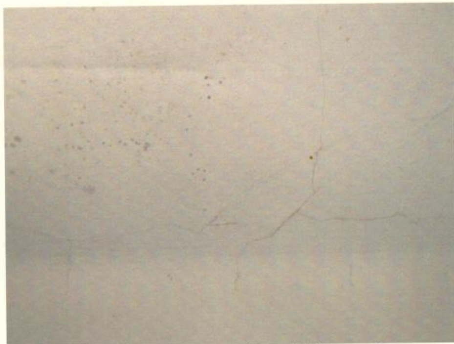
Detalhe do teto e parede do dormitório – manchas e microfissuras na pintura
