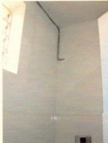
A rede elétrica vai para a sala 368
