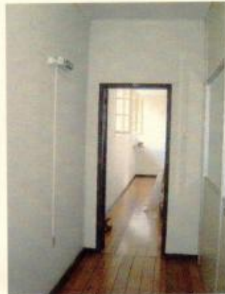
Iluminação de emergência
