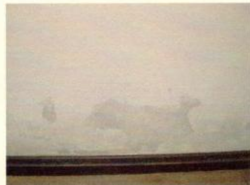
Sala 368 – infiltração que vêm do banheiro
