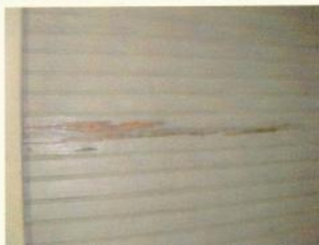
Presença de cupins no forro de madeira
