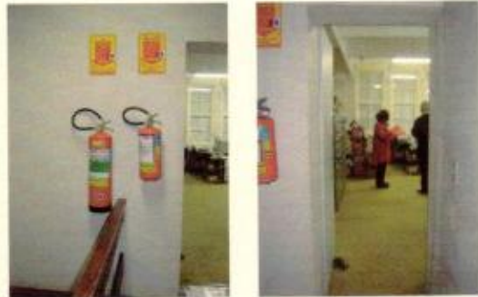
Extintores - Acesso ao acervo biblioteca
