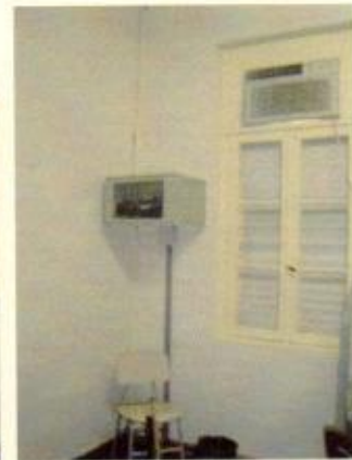
Ar-condicionado e hub
