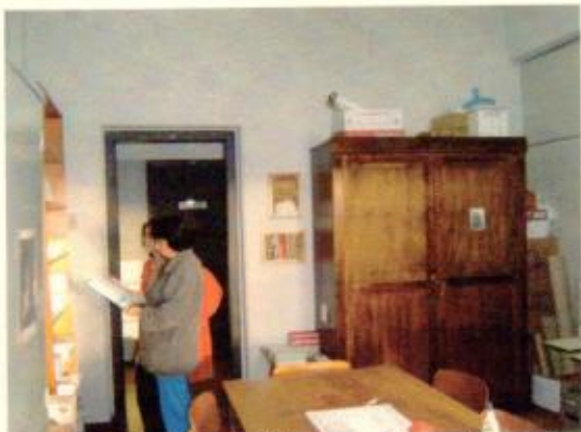
Sala de pesquisa – divisória naval – muitas rachaduras nas paredes
