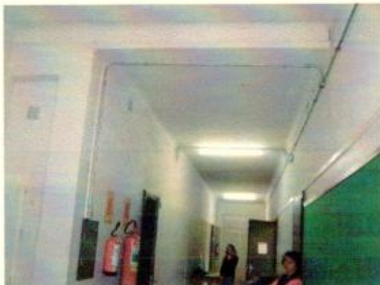
Canaletas, extintores, quadro de força
