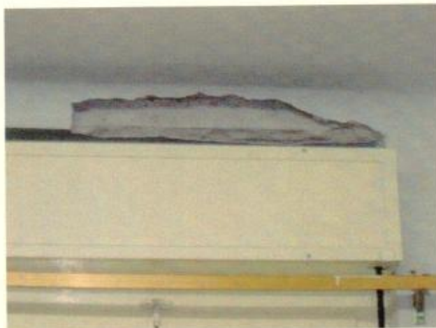
Sala 335 – Reboco quebrado em cima da janela da direita
