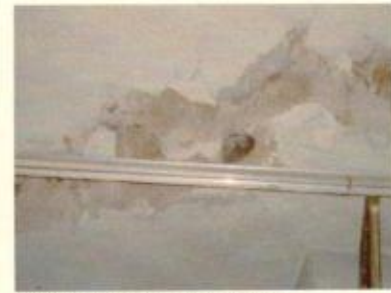
detalhe de bolor no forro
