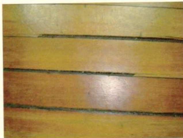
Ação do tempo e dos cupins no pavimento de madeira
