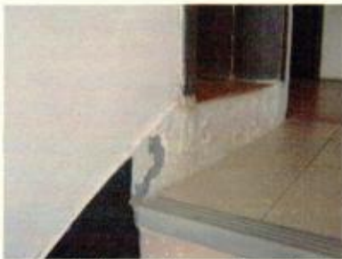
Umidade desnível porta lavanderia
