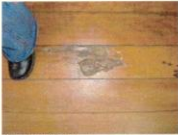
Sala 314 SUL - desgaste no assoalho
