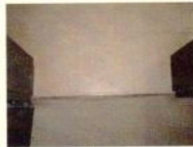
Diferença de piso entre o Corredor e a sala telefonista
