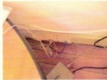
Instalações elétricas posteriores
