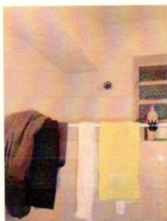
Banheiro sem iluminação natural
