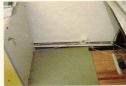
Confluência de fios expostos
