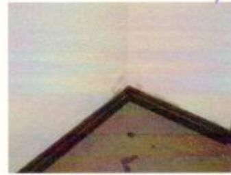
Sinais de umidade nas paredes Piso revestido de forração
