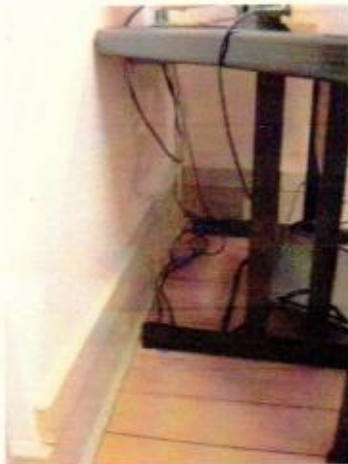
Canaletas inst. elétricas
