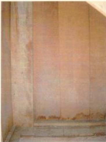
Parede que veda a sala 311
