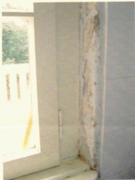
Detalhe da umidade na alvenaria
