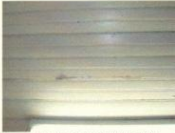
Forro com pintura ruim
