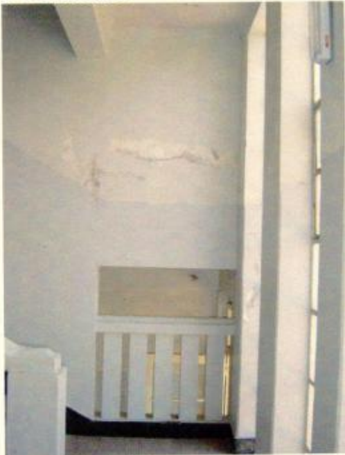
Desgaste da pintura
