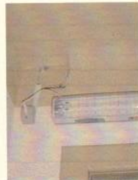
Iluminação de emergência
