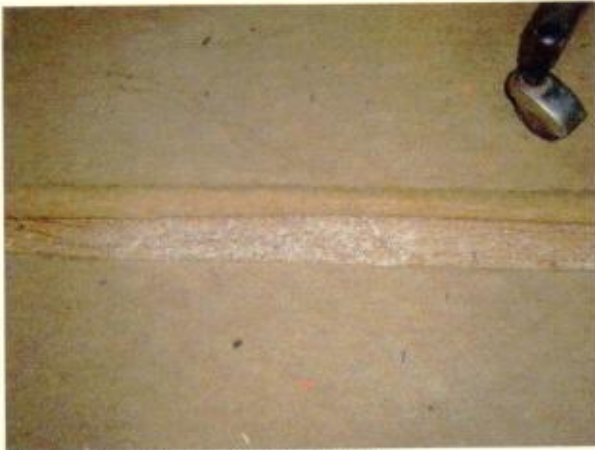
Piso de forração descolado do chão
