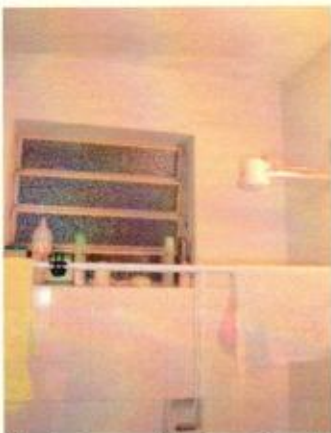
Banheiro sem iluminação natural e sem ventilação
