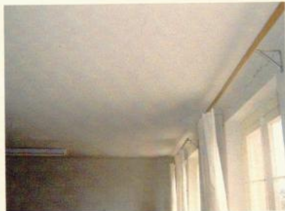
Abaulamento no teto e rachaduras
