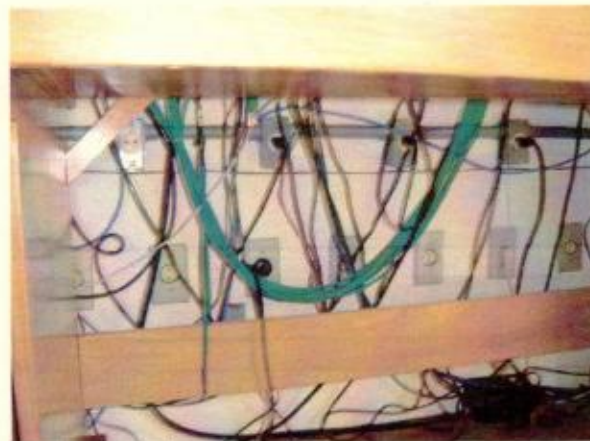
Acúmulo de fios e tomadas
