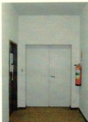
Extintores de água pressurizada e de pó químico
