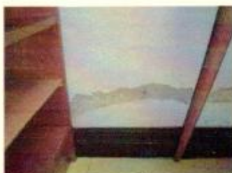
Sala 371 – umidade na parede
