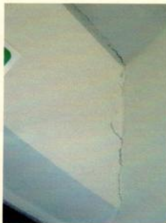
Rachadura na viga
