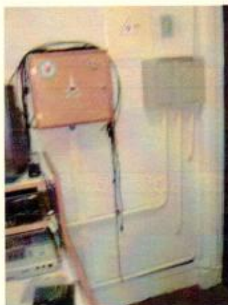
Centrais de distribuição de energia
