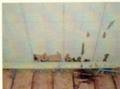
Danos causados por cupins
