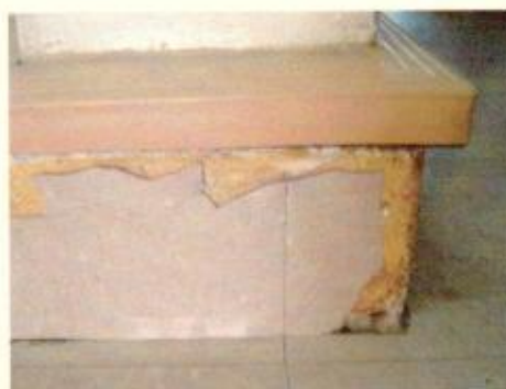
Detalhe - placas vinílicas desgastadas sob o revestimento de granitina
