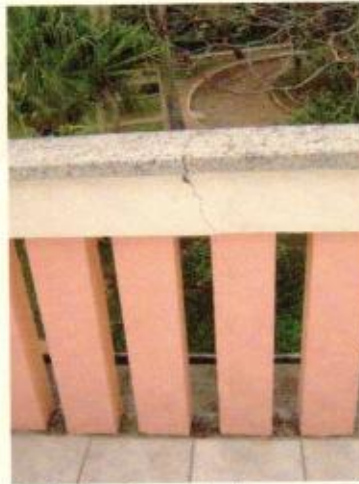
Rachadura importante no parapeito
