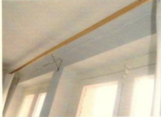
Rachaduras superficiais acima das janelas
