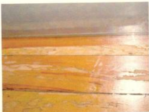
Assoalho danificado pela ação dos cupins
