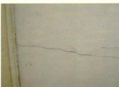
Sala 304 – rachaduras superficiais na alvenaria
