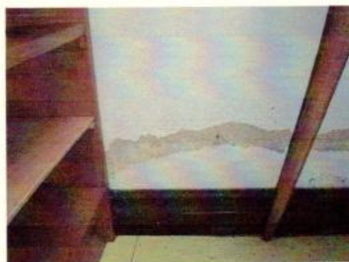
Sala 371 – umidade na parede do lado do depósito
