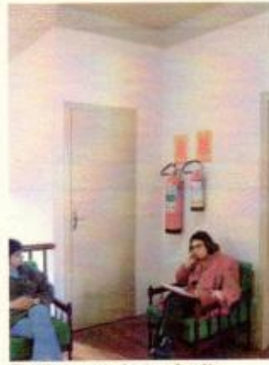
Extintores de incêndio
