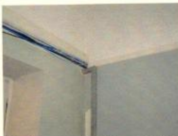
Fios à mostra, fora das canaletas aparentes
