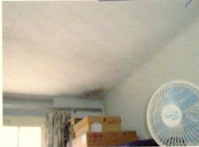
Umidade no forro denunciando infiltrações
