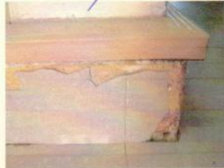
Detalhe – placas vinílicas desgastadas sob o revestimento de granitina
