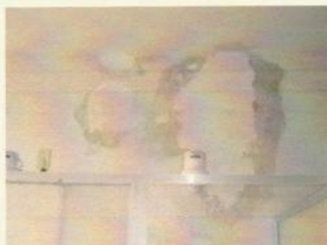
Manchas provocadas pela umidade
