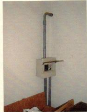
Centro de distribuição energia
