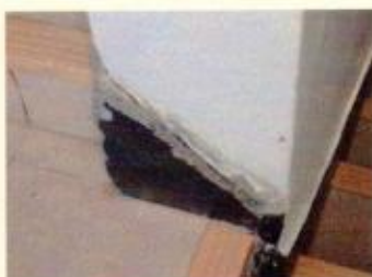
Detalhe rodapé rachado
