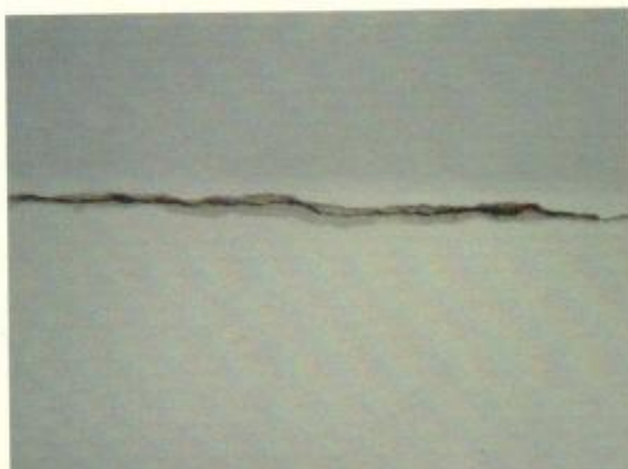
Detalhe- rachadura importante no estuque da sala de pesquisa
