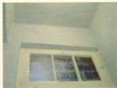
Umidade acima da porta
