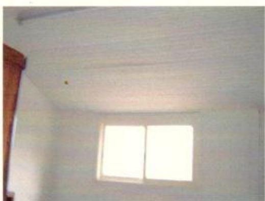
Paredes de madeira com pintura recente, mas danificadas pela ação do tempo
