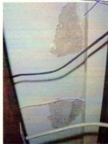
Detalhe - umidade parede
