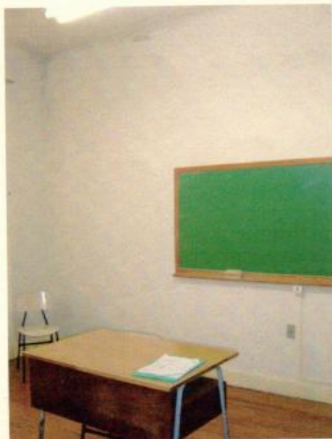
Sala 382 – umidade no canto da parede
