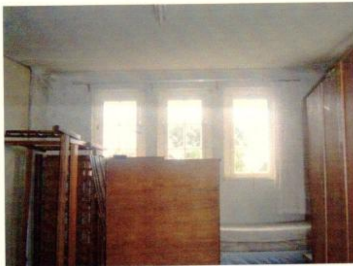
Sala 321 – sinais visíveis de falta de ventilação e umidade
