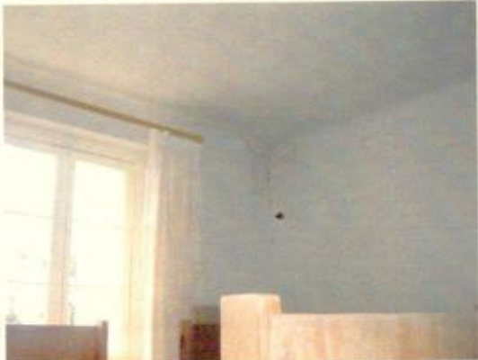
Sala 324 - umidade no canto
