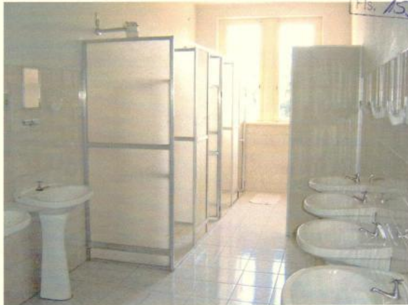
Banheiro com acesso pelo corredor – alguns equipamentos estragados
