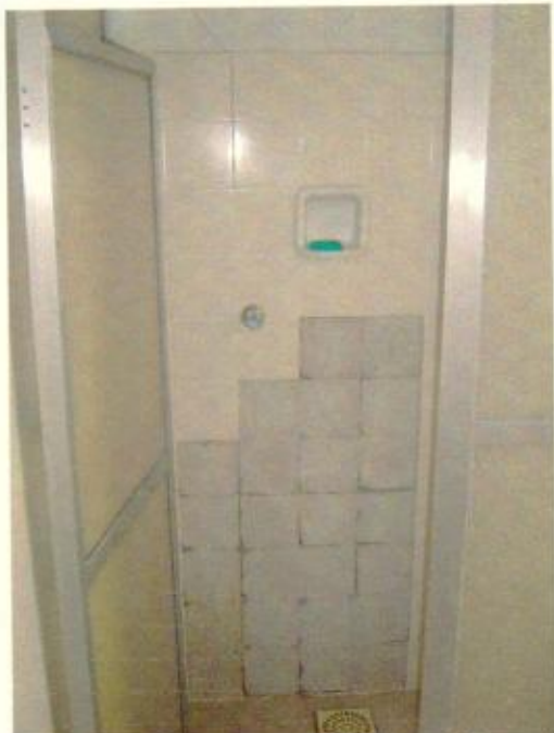
Banheiro com acesso pela sala 324 – falta azulejos Sinais de umidade pelas paredes
