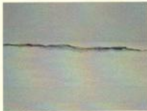
Rachaduras no estuque
