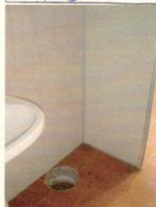
Falta tampa do ralo
