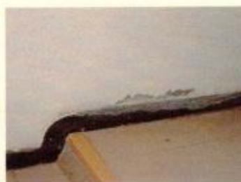
Umidade no rodapé
