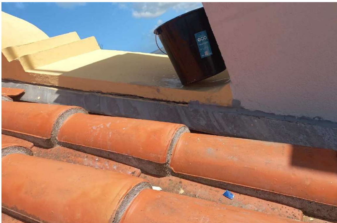
Foto 46 – Reparos e vedações junto ao algeroz na parte posterior da fachada principal.
