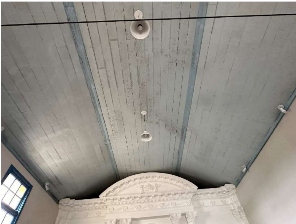
Foto 11 - Vista altar e parte do forro – note-se o mofo no forro.
