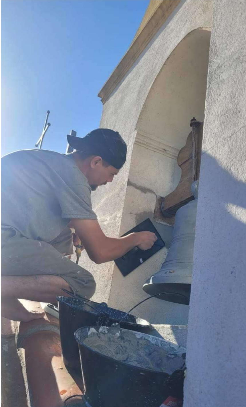
Foto 26 – Correções das rachaduras dos revestimentos em argamassa torre sinos.
