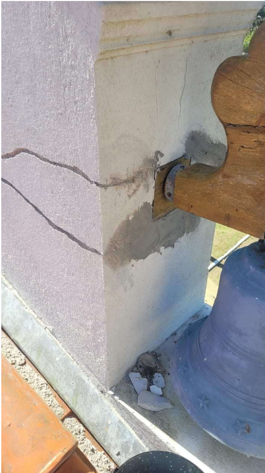
Foto 27 – Correções das rachaduras dos revestimentos em argamassa torre sinos.
