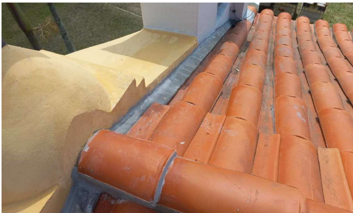
Foto 47 – Reparos e vedações junto ao algeroz na parte posterior da fachada principal.
