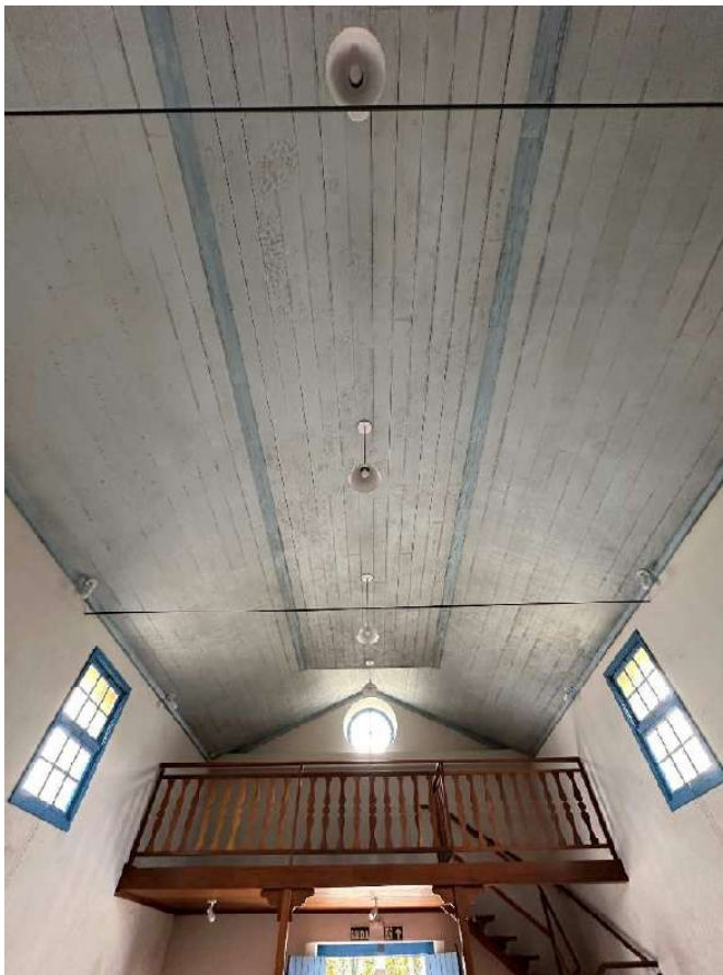
Foto 14 - Vista do forro e mezanino – note-se o mofo no forro.
