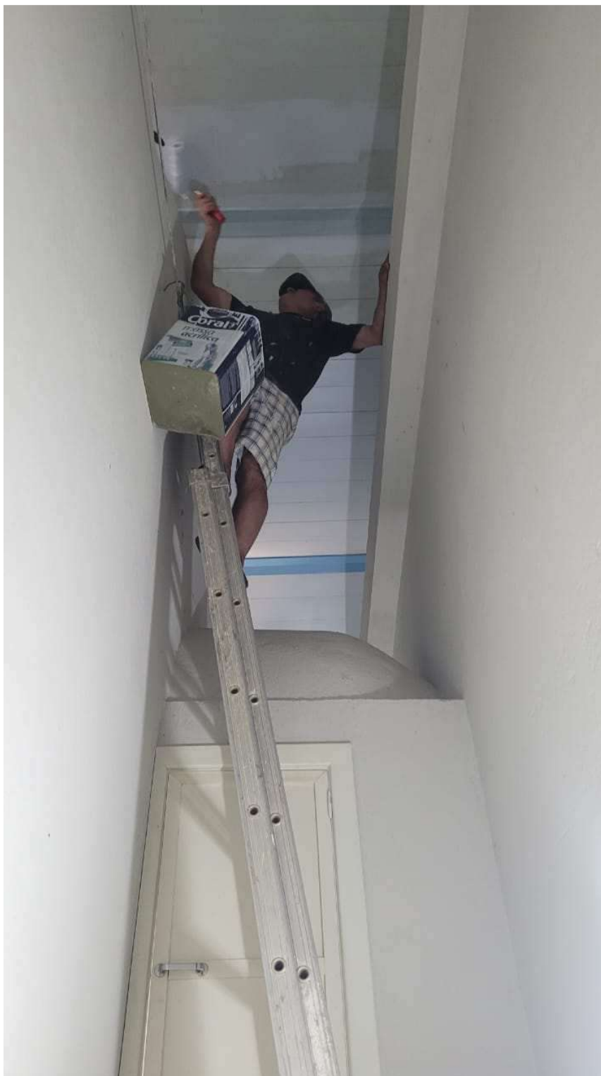
Foto 23 – Pintura do forro nave principal atrás do altar.
