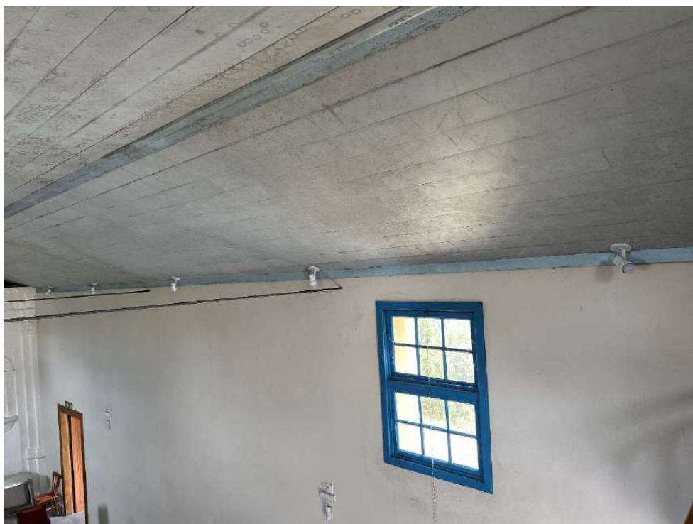
Foto 20 - Vista interna forro – note-se o mofo.
