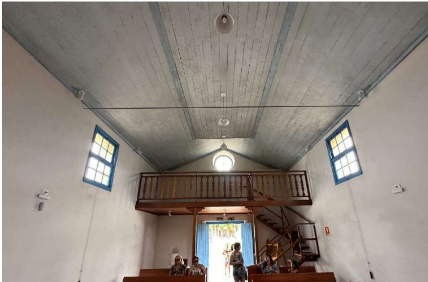
Foto 13 - Vista do forro e mezanino – note-se o mofo no forro.
