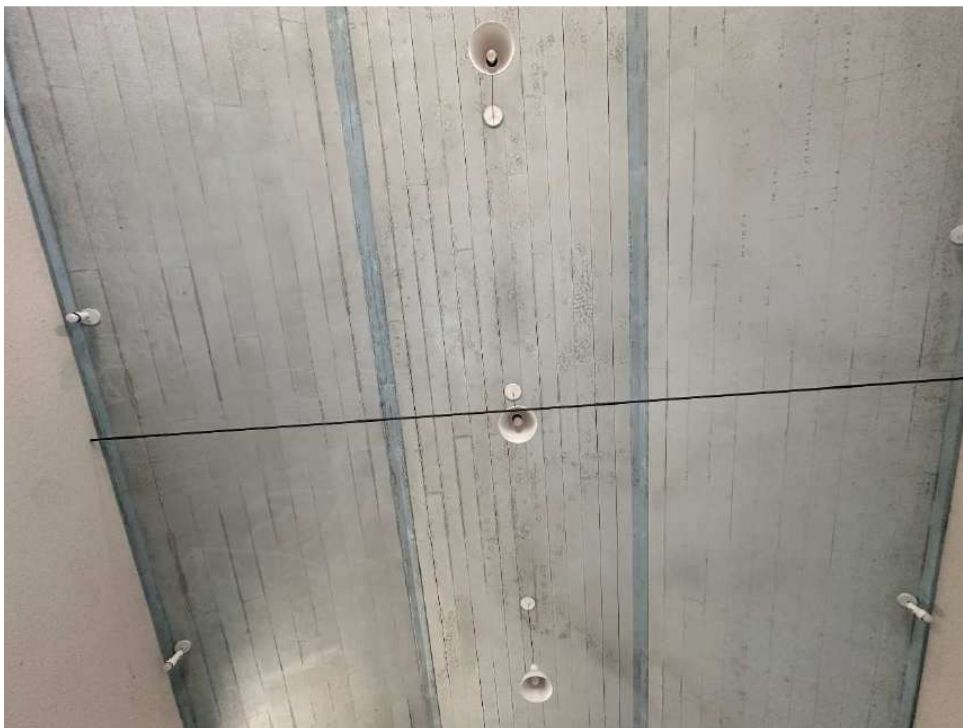
Foto 12 - Vista do forro – note-se o mofo no forro.
