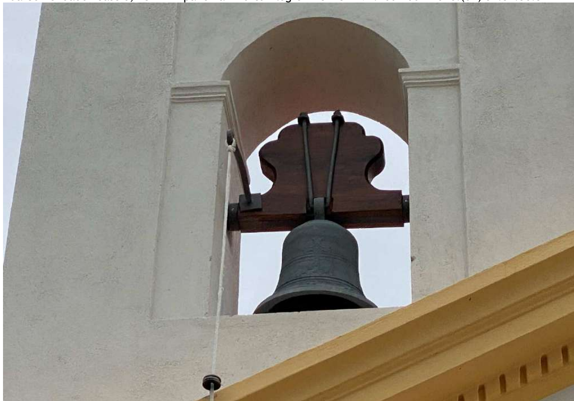
Foto 34 – Sino instalado, e com corda para acionamento.
