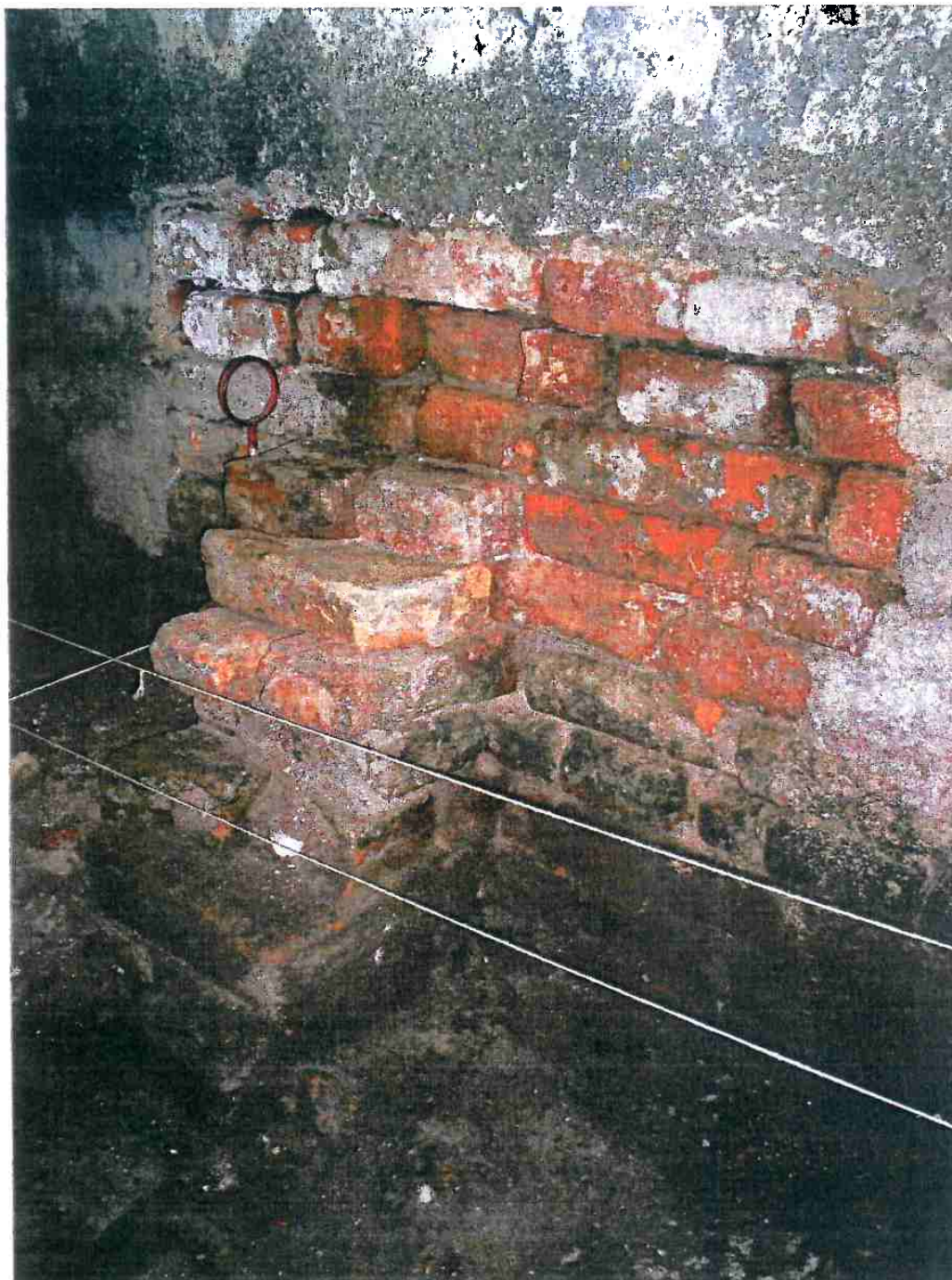
Figura 113 – parte das fundações expostas pela escavação demonstrando a espera para uma parede que não foi construída ou que pode ter sido demolida . Foto: SUPETEC
