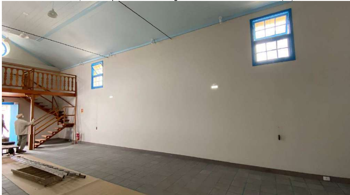
Foto 52 – Iluminação de emergência e extintor de incêndio próximo a escada do coro da nave principal.
