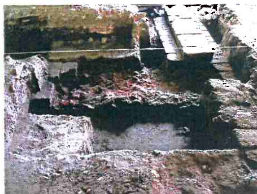
Figura 62 – parte destruída da sapata.
