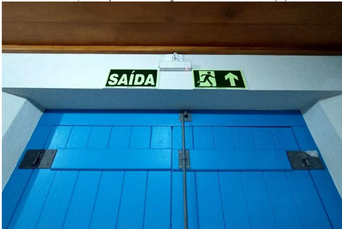
Foto 50 – Iluminação de emergência e placas indicativas sobre a porta acesso à nave principal.
