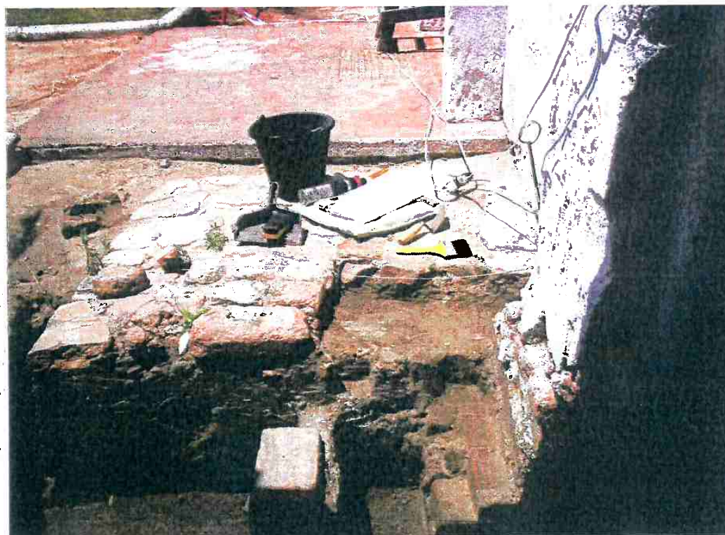
Figura 125 – fundações no canto da parede norte da Capela. Não se percebe neste trecho anomalia que comprometa a segurança. Observa-se um acabamento na base da coluna oculto pelo aumento de nível no terreno. Um pavimento de tijolos descoberto, e a calçada de acesso a capela em nível mais alto. Foto: SUPETEC
