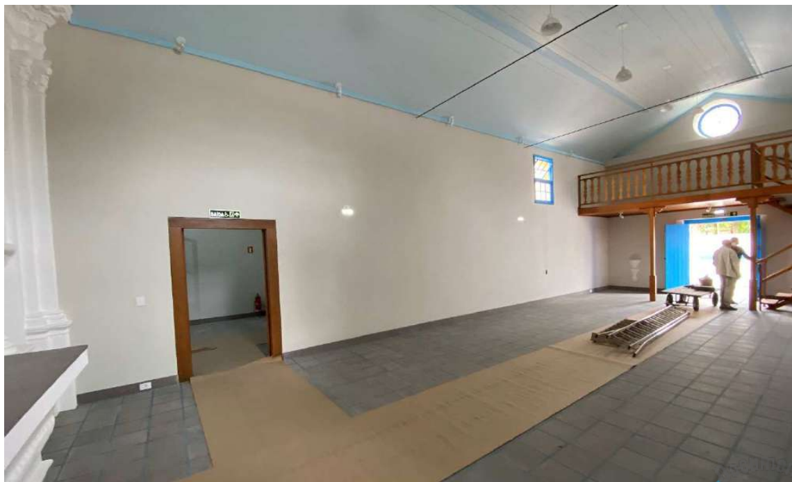
Foto 51 – Iluminação de emergência e placa indicativa na porta acesso sacristia e porta acesso da nave principal.
