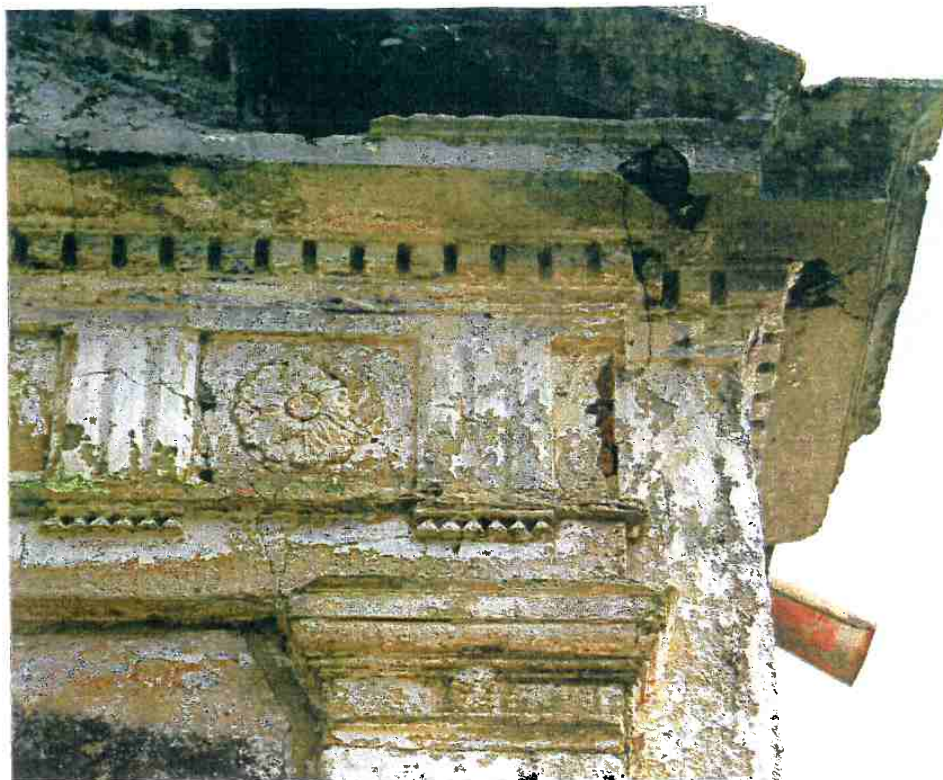
Figura 21 – detalhe do canto direito superior da fachada frontal da capela Nossa Senhora da Conceição demonstrando a deterioração de ornamentos e cobertura e as diversas camadas de tinta ainda identificáveis.
