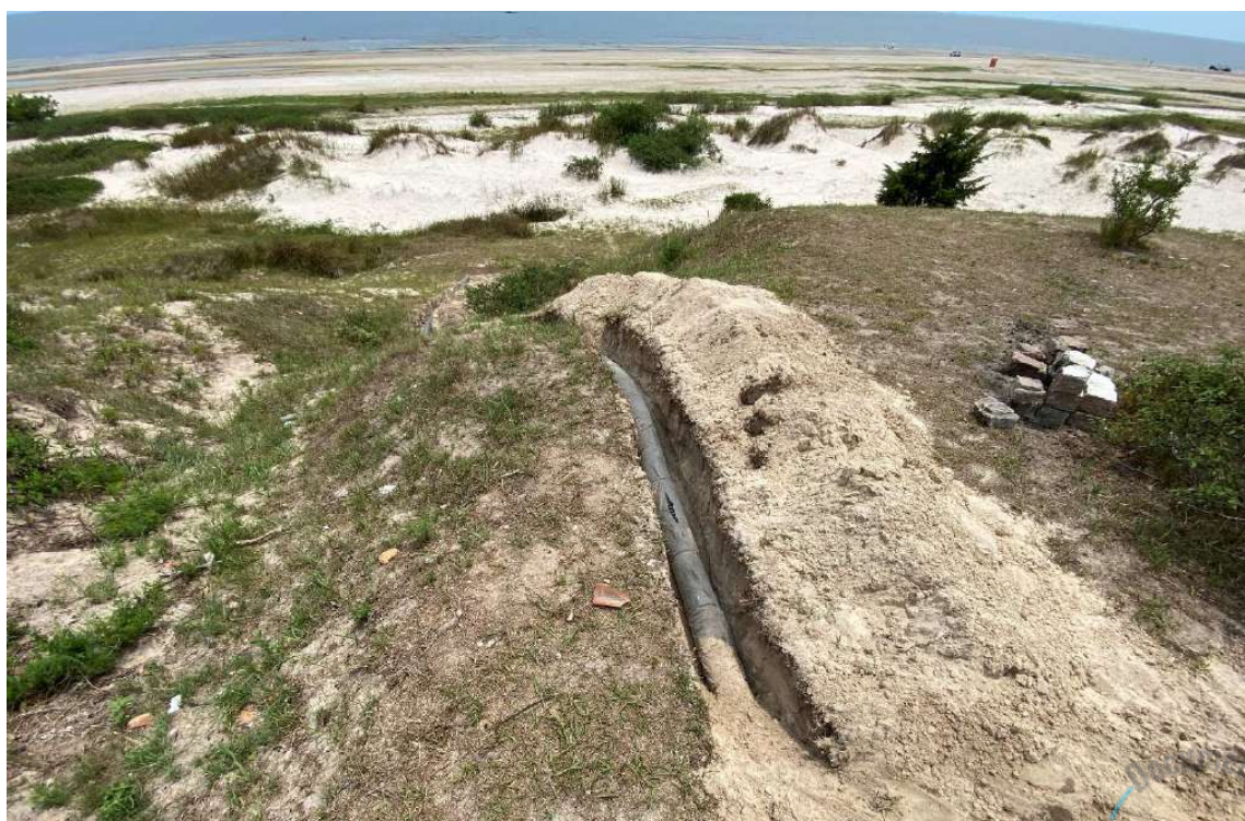
Foto 71 – Redes drenos externos.
