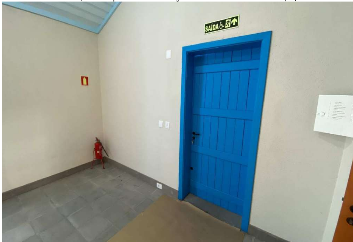
Foto 48 – Extintor de incêndio e placa indicativa saída da sacristia, porta abre para fora.
