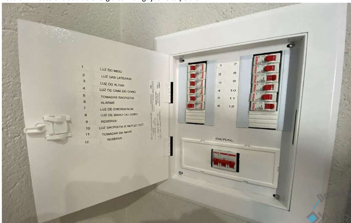
Foto 63 – Centro de distribuição com a identificação dos disjuntores.
