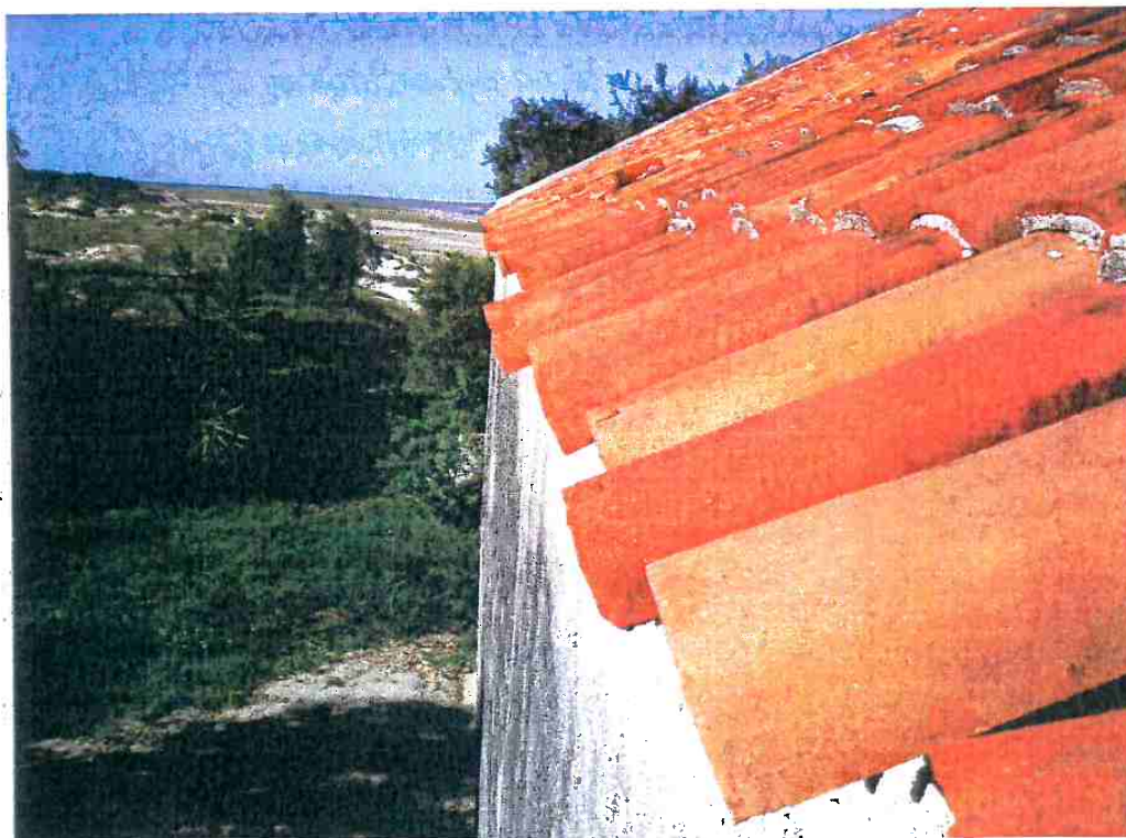
Figura 131 – pode-se observar a situação do beiral leste, que apresenta condição semelhante ao da fachada leste, com desalinhamento de telhas, pouco comprimento e inclinação única. Foto: Rita Gnutzmann Veiga, 2009.
