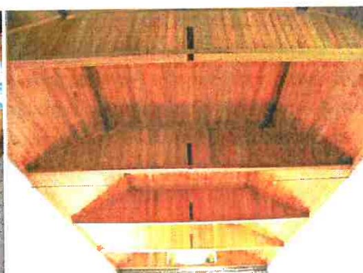
Figura 127 – vista do forro no sentido altar-acesso. Pode-se observar o conflito visual entre o óculo da fachada norte, a tesoura e uma viga instalada em intervenções anteriores. Foto: SUPETEC, 2009.
