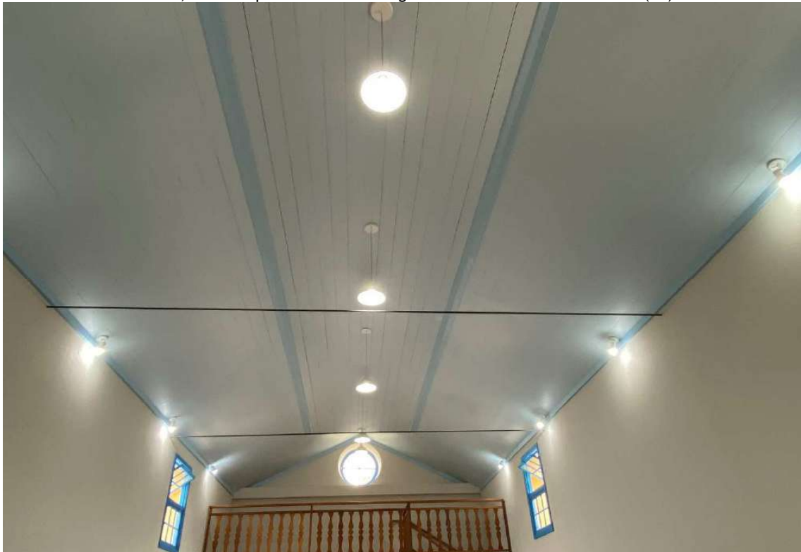
Foto 64 – Luminárias na nave principal.
