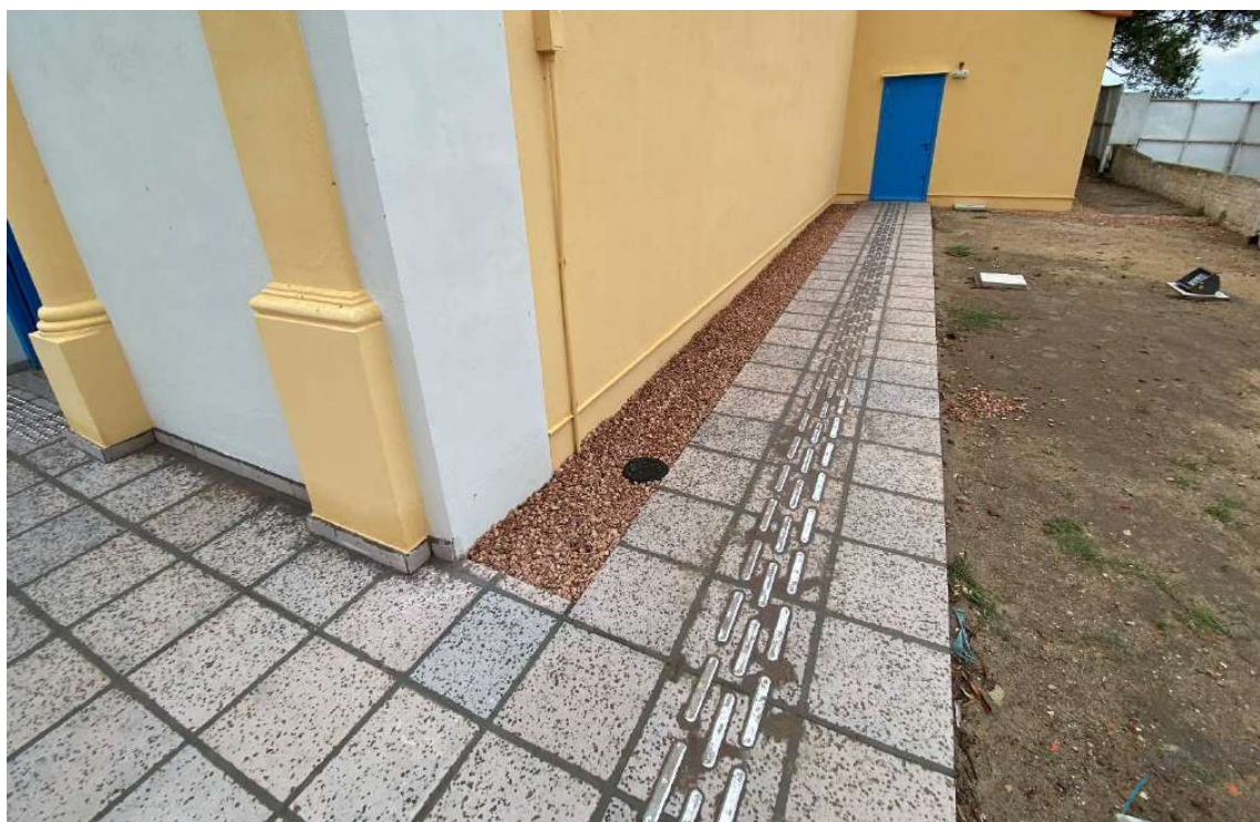
Foto 55 – Piso tátil direcional acesso sacristia.
