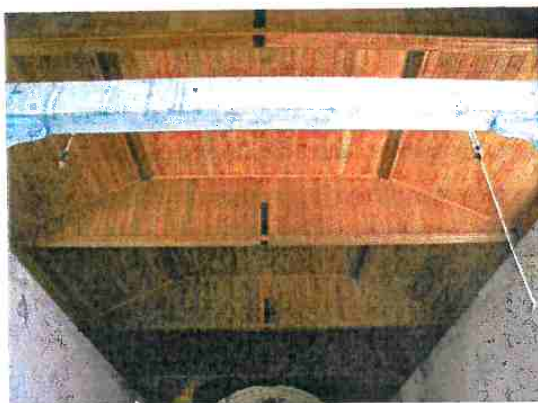
Figura 126 – vista do forro no sentido acesso-altar. Pode-se observar o conflito visual entre forro e o frontão curvo. Foto: SUPETEC, 2009.
