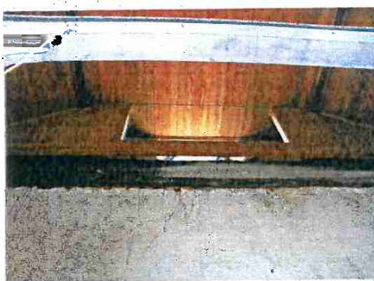
Figura 128 – detalhe da área em frente ao óculo, mostrando a visual do mesmo totalmente obstruída. Foto: SUPETEC, 2009.
