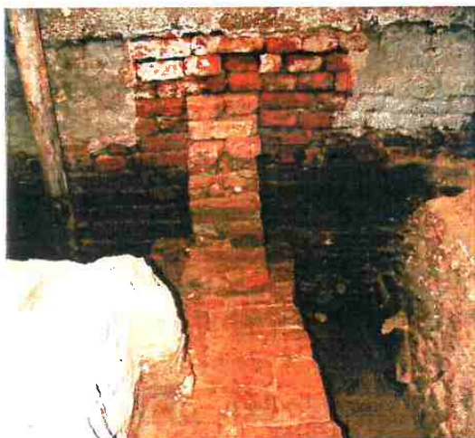
Figura 61 – cicatriz na parede da capela, no nível da sapata.
