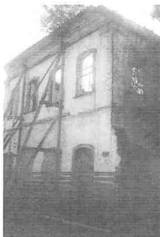
Visualização de escoramento duplo de frontaria, térrea e superior de sobrado em processo de ruína. Rio Pardo.
