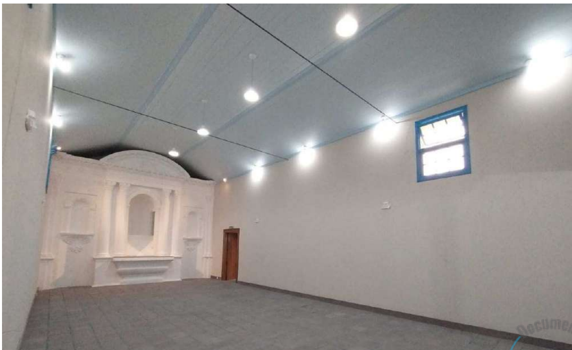
Foto 65 – Luminárias da nave principal.
