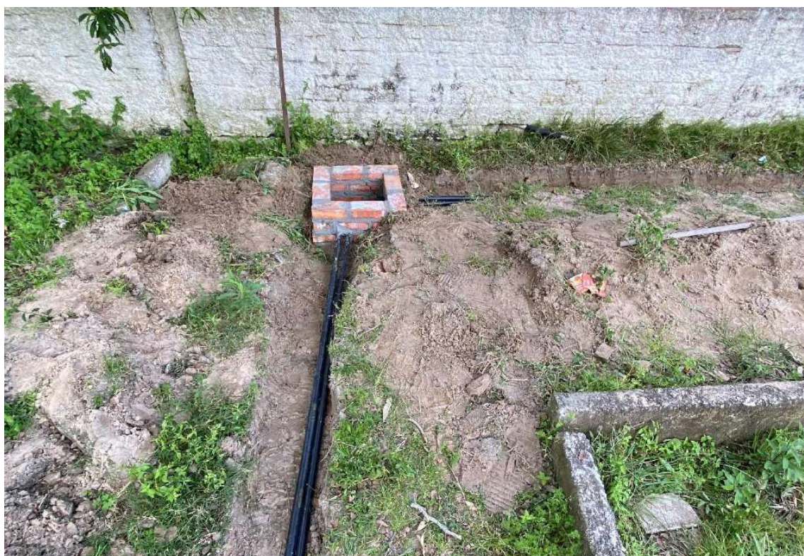
Foto 44 – Caixas de passagem e eletrodutos rede alimentação.
