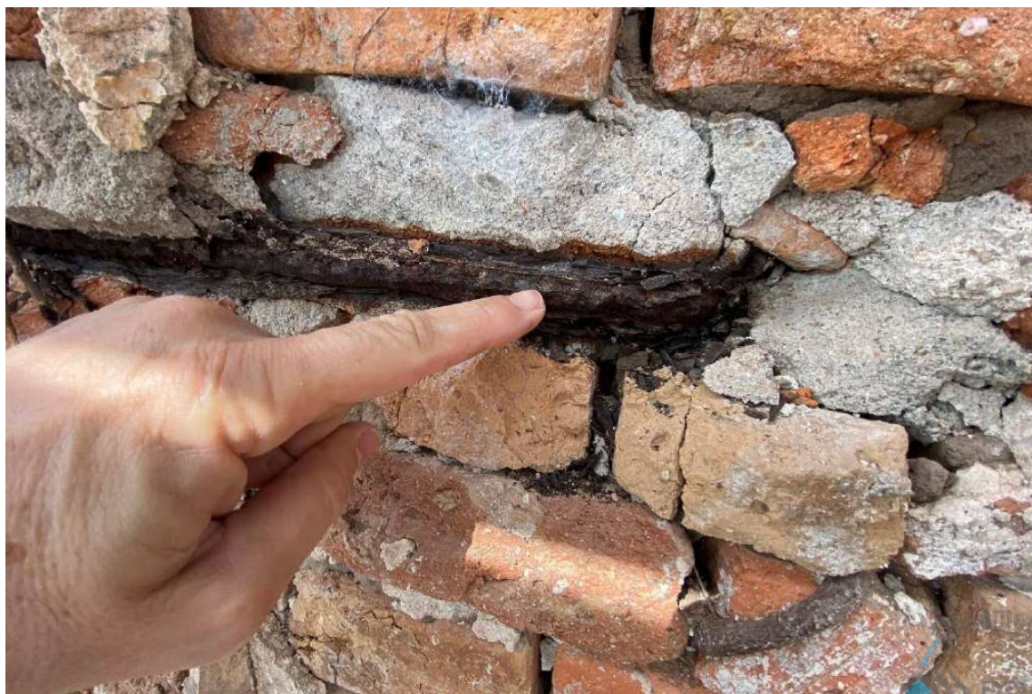
Foto 89 – Verificação do estado de ferro de amarração antigo, totalmente oxidado.
