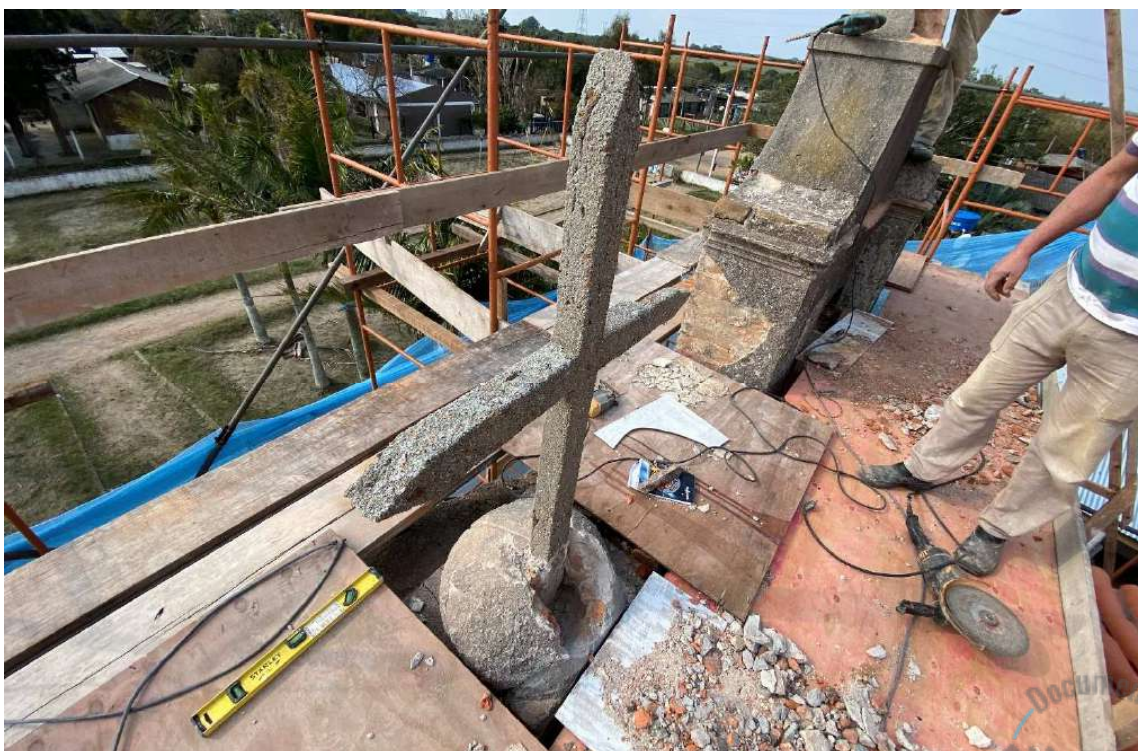
Foto 87 – Registro estado da cruz central.
