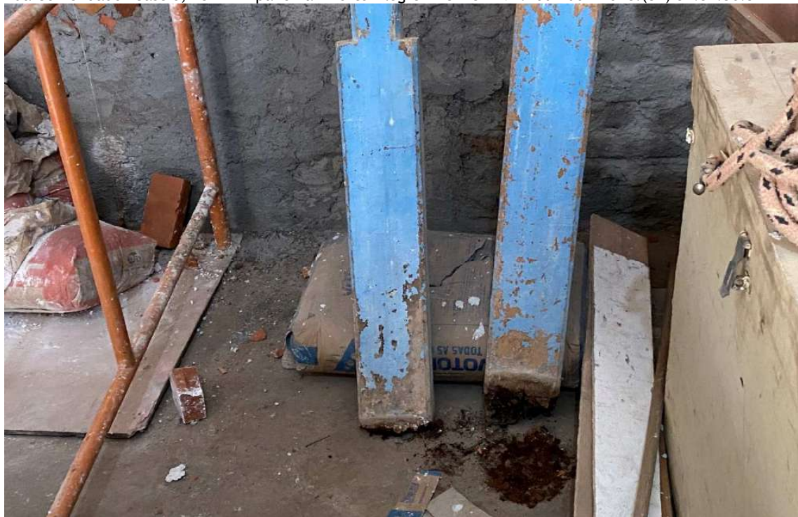
Foto 70 – Detalhe ponta do pilar apodrecida.
