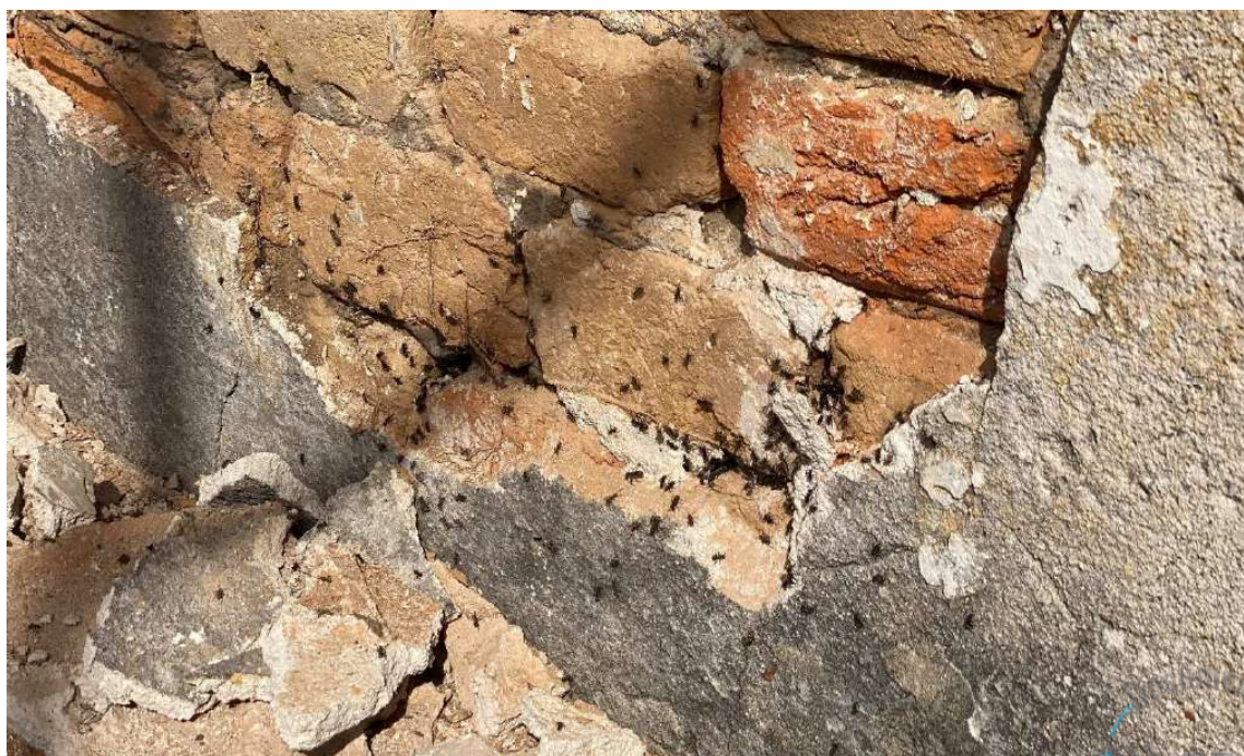
Foto 91- Presença de formigas nas juntas da alvenaria.
