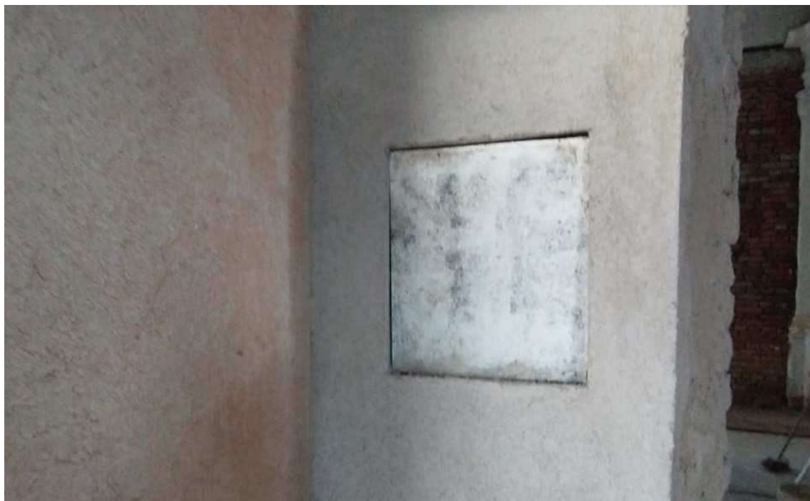
Foto 46 – Instalação do Centro de distribuição.
