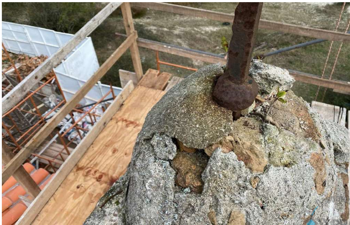
Foto 77 - Registro estado da base da cruz lado oeste antes da remoção.
