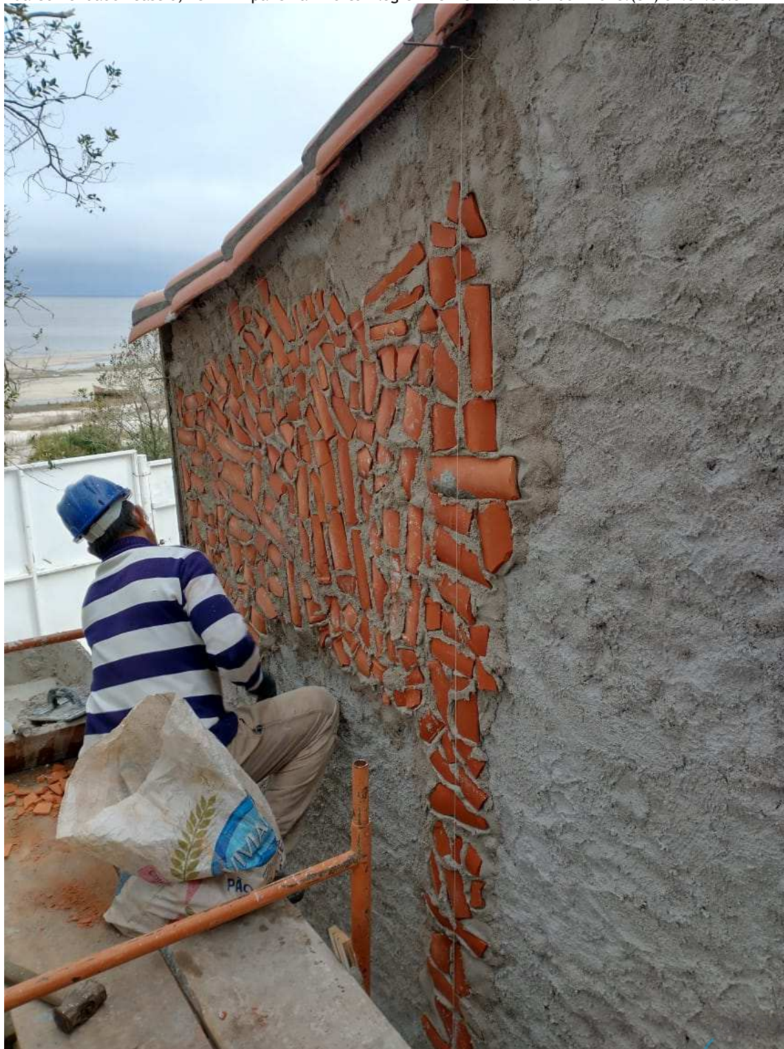
Foto 20 – Encascotamento de parte da parede da fachada sul.
