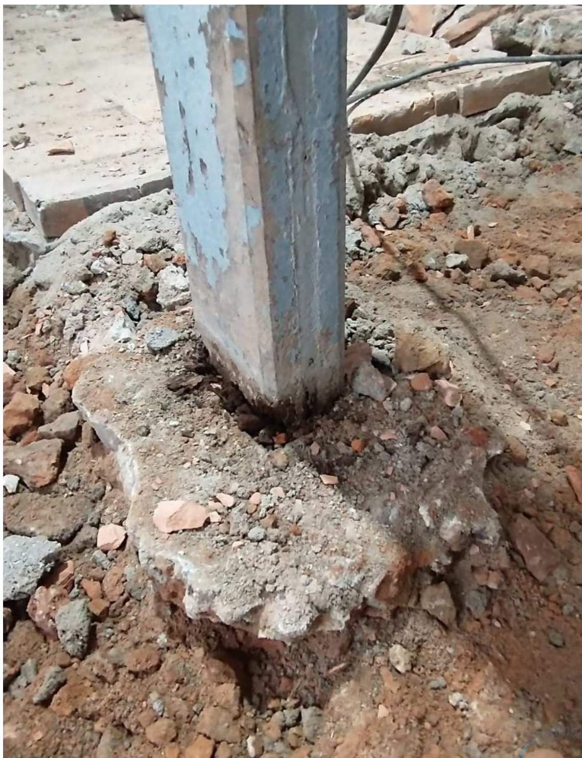
Foto 69 – Detalhe da base do pilar de madeira apodrecida.
