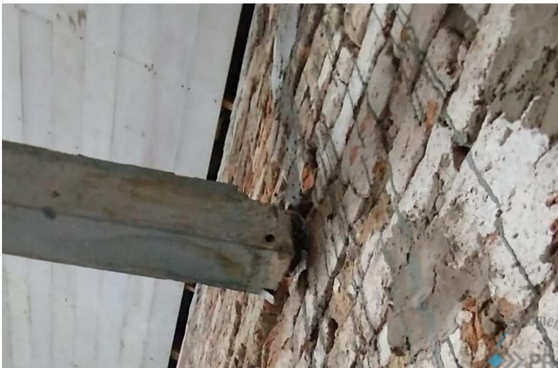
Foto 68 – Detalhe ponta da viga de madeira apodrecida no apoio.
