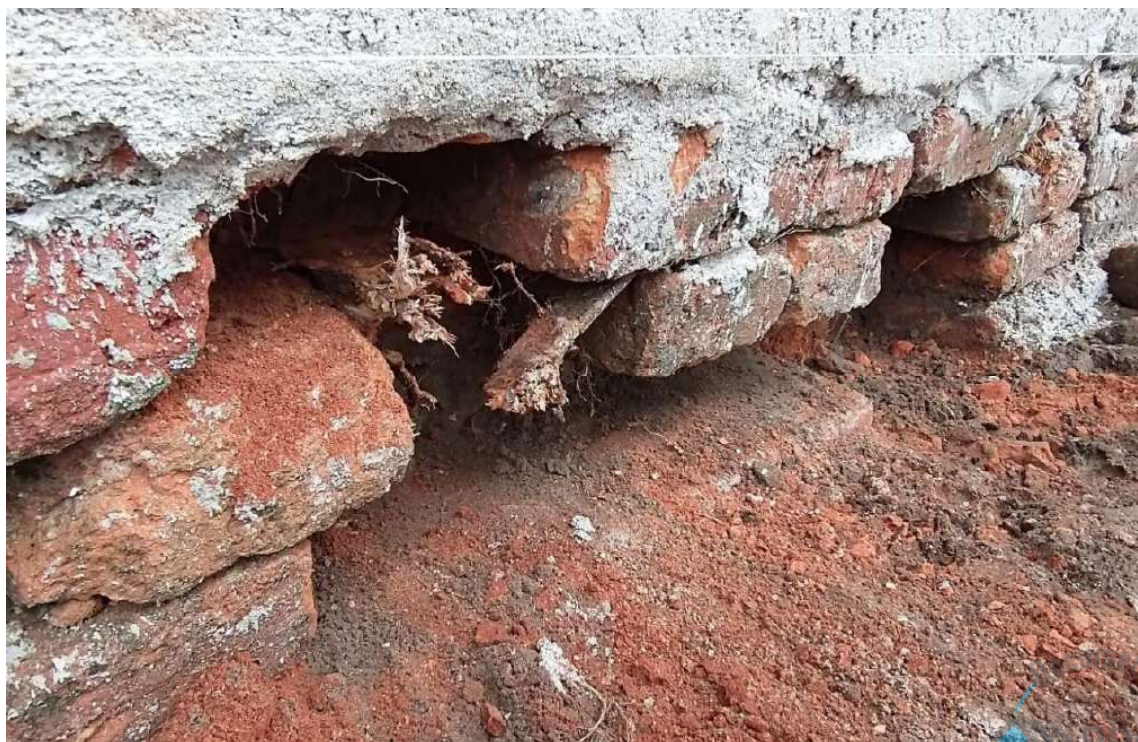
Foto 11 – Presença de raiz de arbustos nas fundações.
