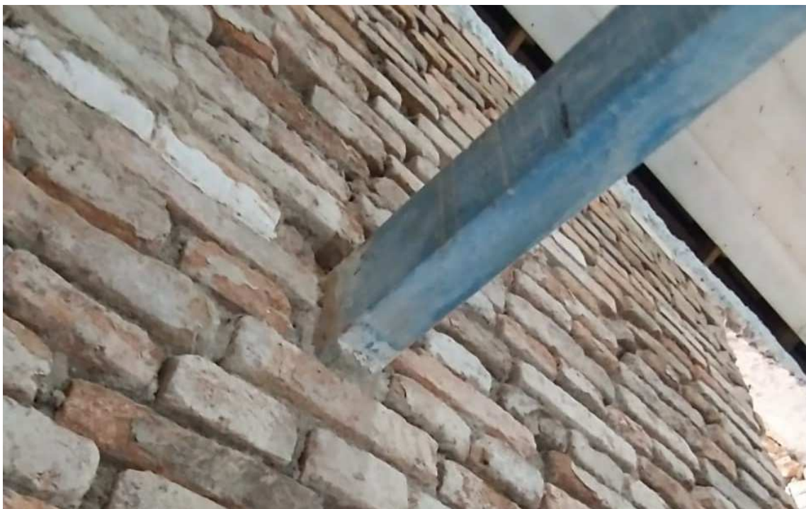
Foto 67 – Detalhe ponta da viga de madeira apodrecida no apoio.
