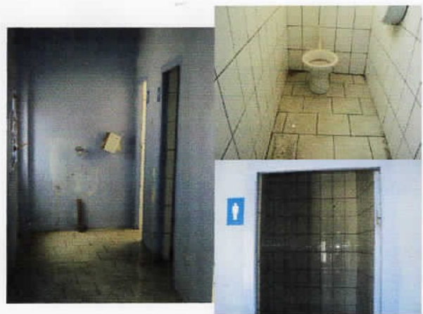
3 Pisos e revestimentos em cerâmica esmaltada.
