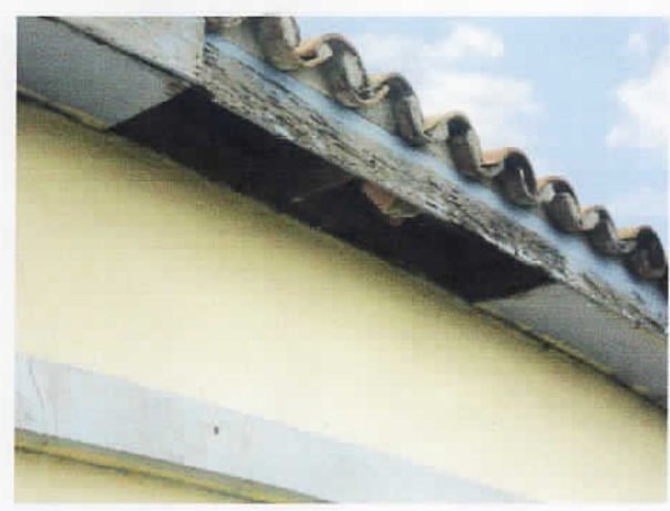
3 Beiral com fechamento em madeira. Estado de conservação ruim.
