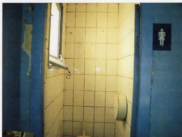
2 Sanitário feminino. Detalhe da janela solta.
