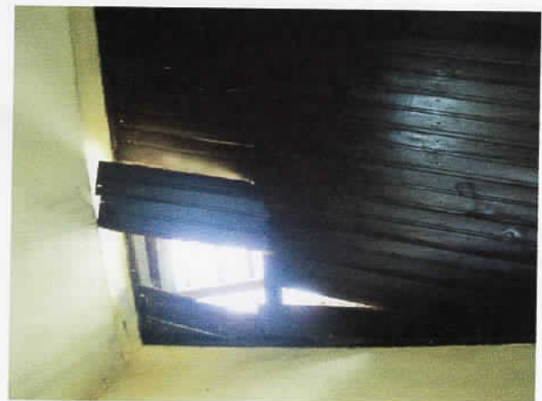
3 Forro em madeira tipo régua macho-fêmea. estado de conservação ruim.
