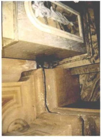
CT_EE_041: perda de material e rede elétrica aparente
