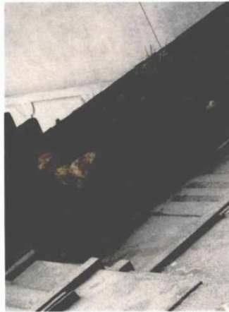
RE 25 - VEGETAÇÃO RE 11 - PERDA DE REVESTIMENTO
