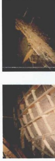
Sujidades generalizadas no estuque na nave central e ataque de insetos xilófagos no madeiramento do estuque da cúpula, no lado sudoeste.
