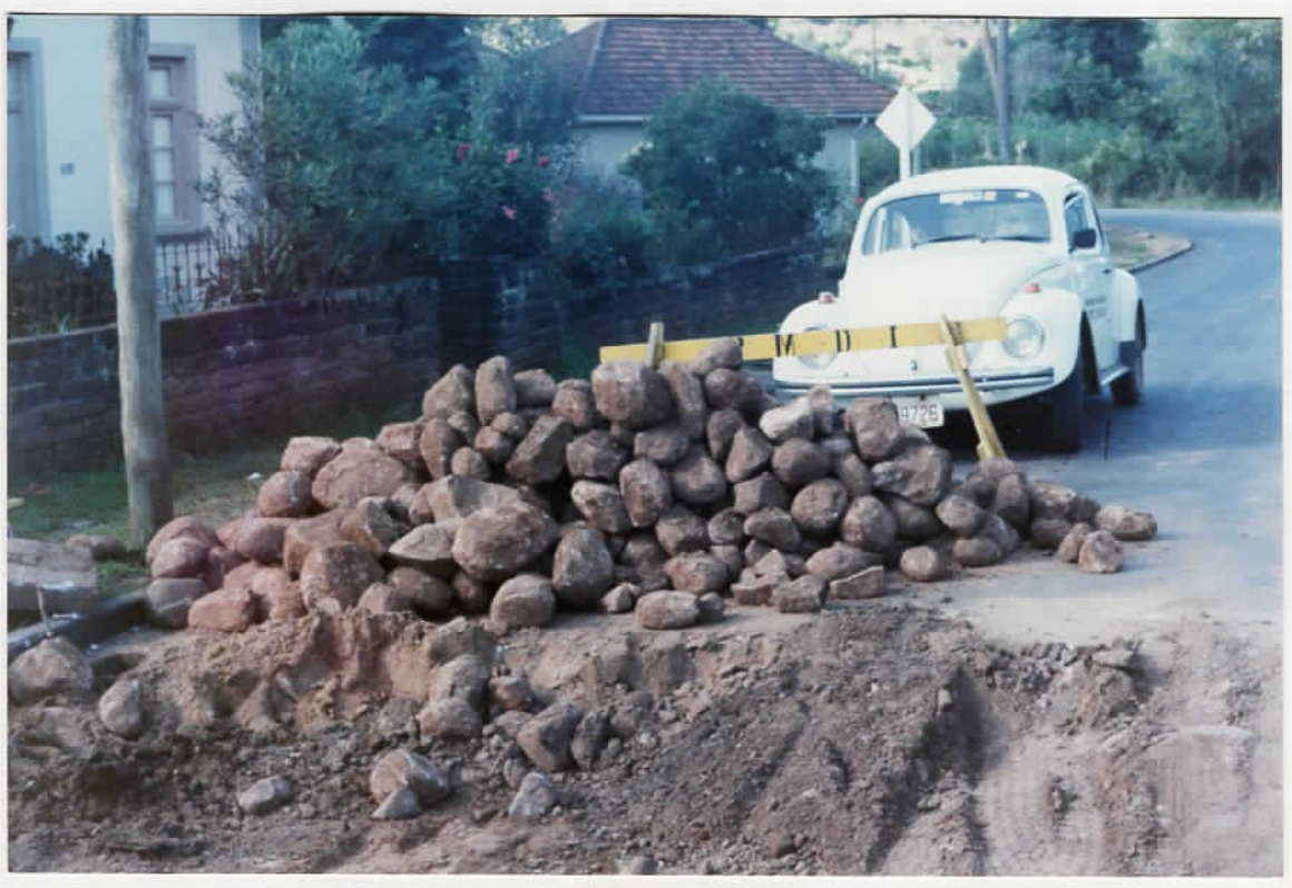
Pedras do leito (pavimentação) da ponte sobre o Arroio Feiteira quando de sua recuperação em abril de 1995.
