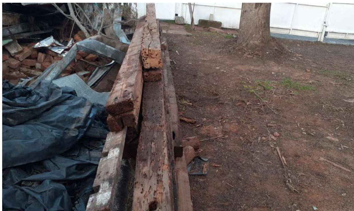
Foto 28 – Estado dos barrotes entrepiso removidos, totalmente atacados por insetos xilófagos.
