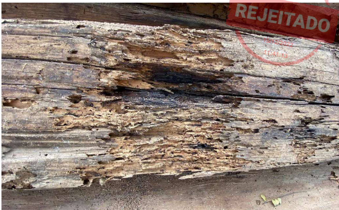
Foto 25 – Estado dos barrotes entrepiso removidos, totalmente atacados por insetos xilófagos.
