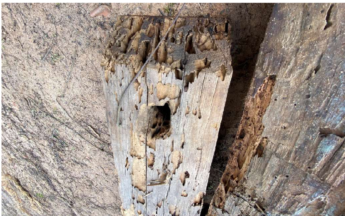
Foto 26 – Estado dos barrotes entrepiso removidos, totalmente atacados por insetos xilófagos.
