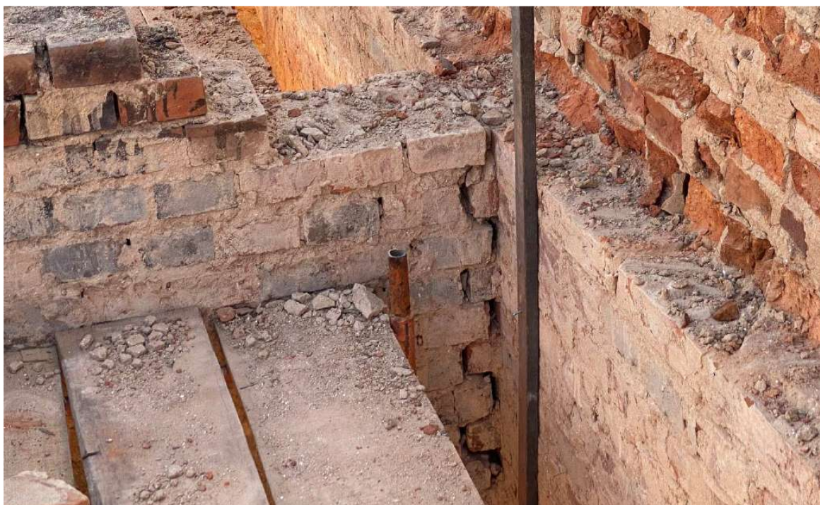
Foto 12 – Detalhe da rachadura da parede interna com a parede externa no compartimento arquivo histórico.
