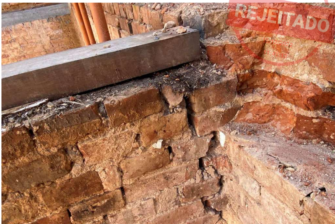
Foto 11 – Detalhe da rachadura da parede interna com a parede externa no compartimento arquivo histórico.
