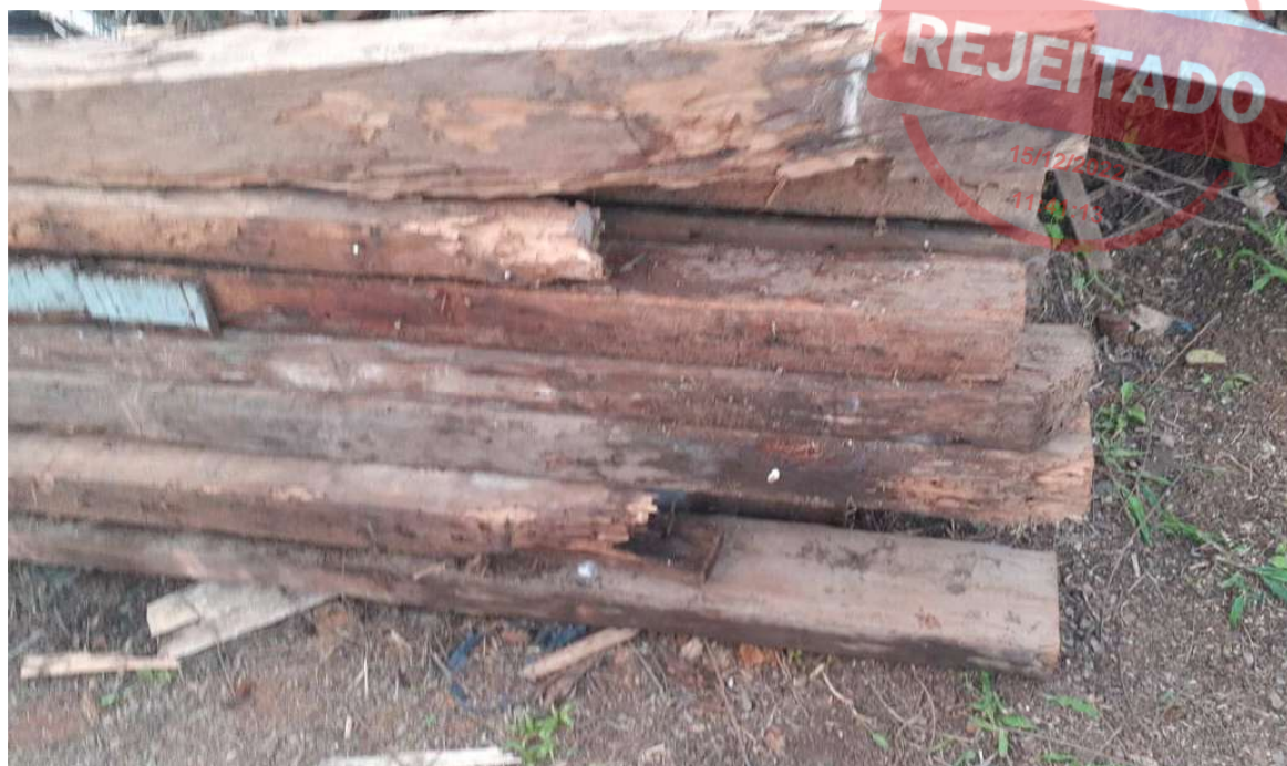
Foto 27 – Estado dos barrotes entrepiso removidos, totalmente atacados por insetos xilófagos.
