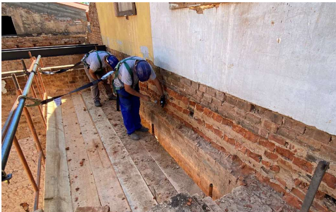
Foto 10 – Demolição parcial da alvenaria para execução das cintas e coxins, nível entrepiso
