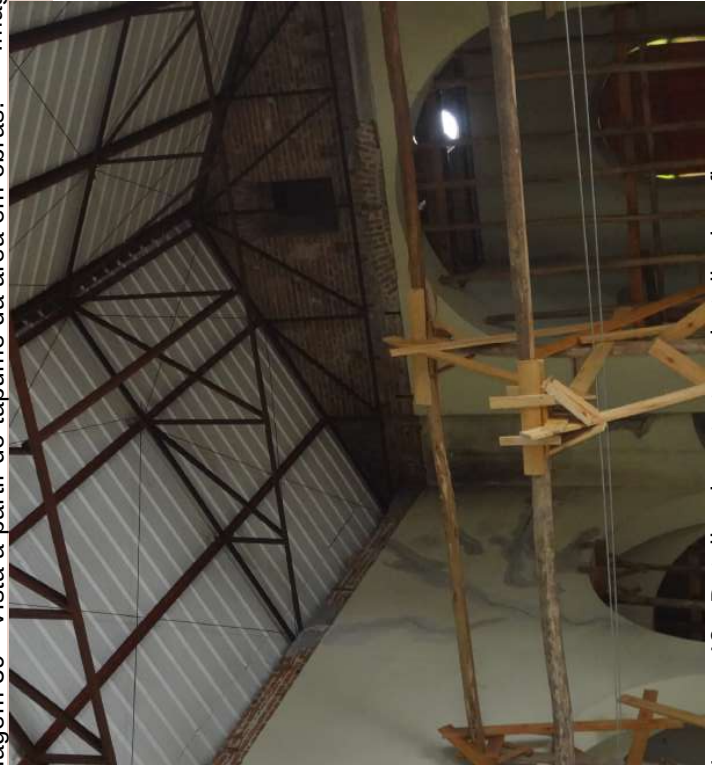
Imagem 42 - Detalhe da estrutura do telhado e fissuras.
