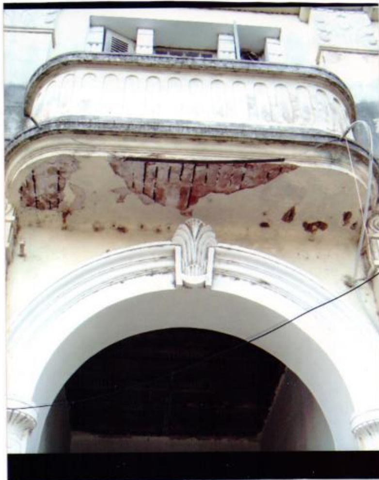
Presença de descolamento de rebocos sob as sacadas existentes sobre o passeio público. Com evidência para a armadura de ferro oxidada e aparente
