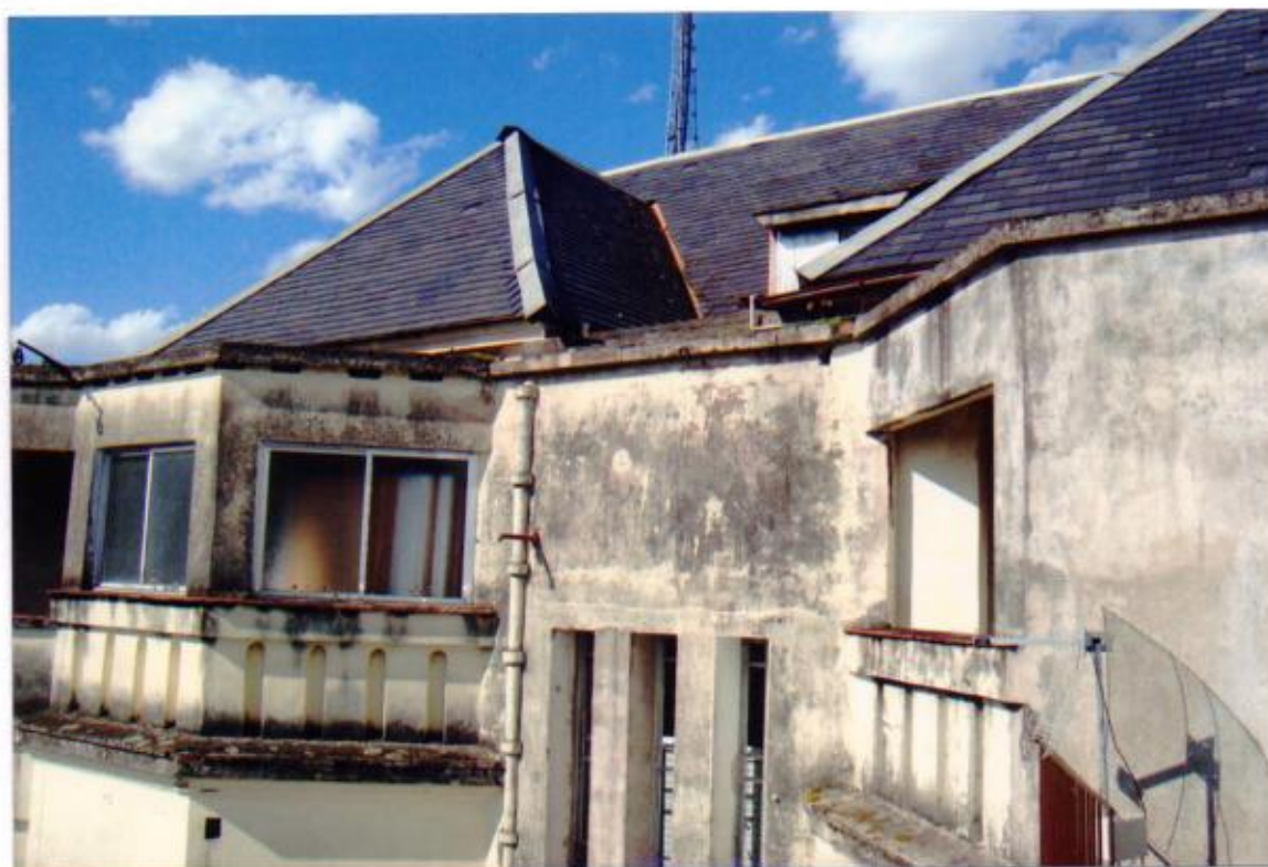
Detalhe do conjunto de telhados, evidenciando a desordem dos elementos em metal, aliado a presença de telhas cerâmicas esmaltadas planas a serem substituídas por telhas cerâmicas tipo francesas.
