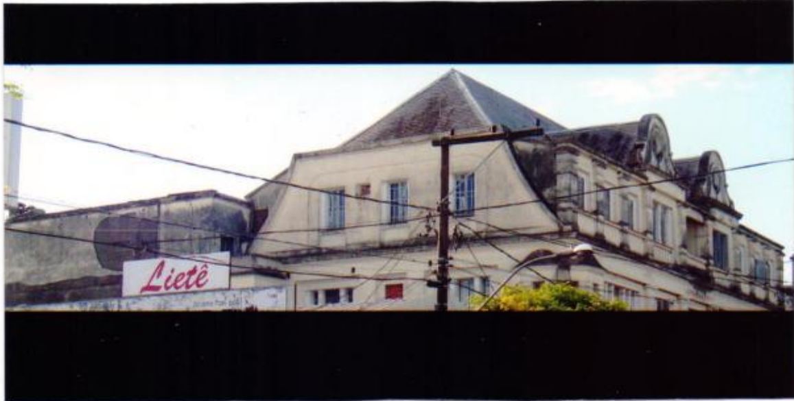
Presença de grande descolamento de rebocos na face sul, oriundas de um incêndio ocorrido na edificação vizinha, comprometendo toda a extensão de revestimentos.
