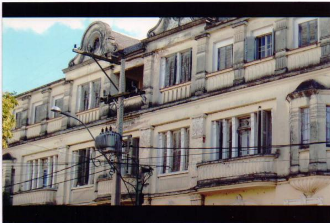
Conjuntos de esquadrias da fachada principal do prédio a serem restauradas, face à inexistência de proteção as mesmas ao longo dos anos
