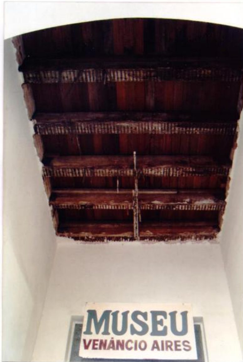
Acesso principal do prédio, onde ocorreu o total descolamento do estuque e base, face às constantes infiltrações
