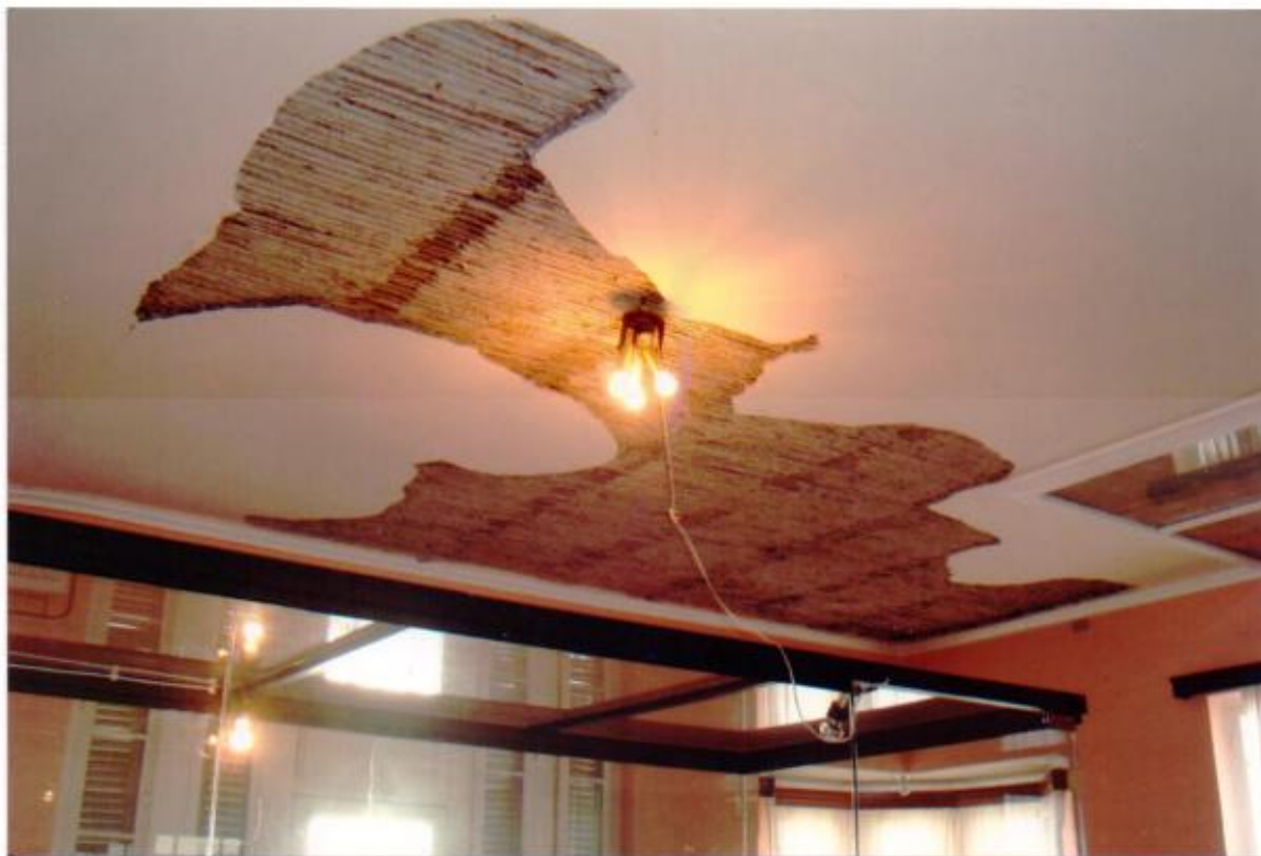
Área com presença de descolamento parcial do estuque, cuja base de sustentação em fibra natural apresenta-se em decomposição
