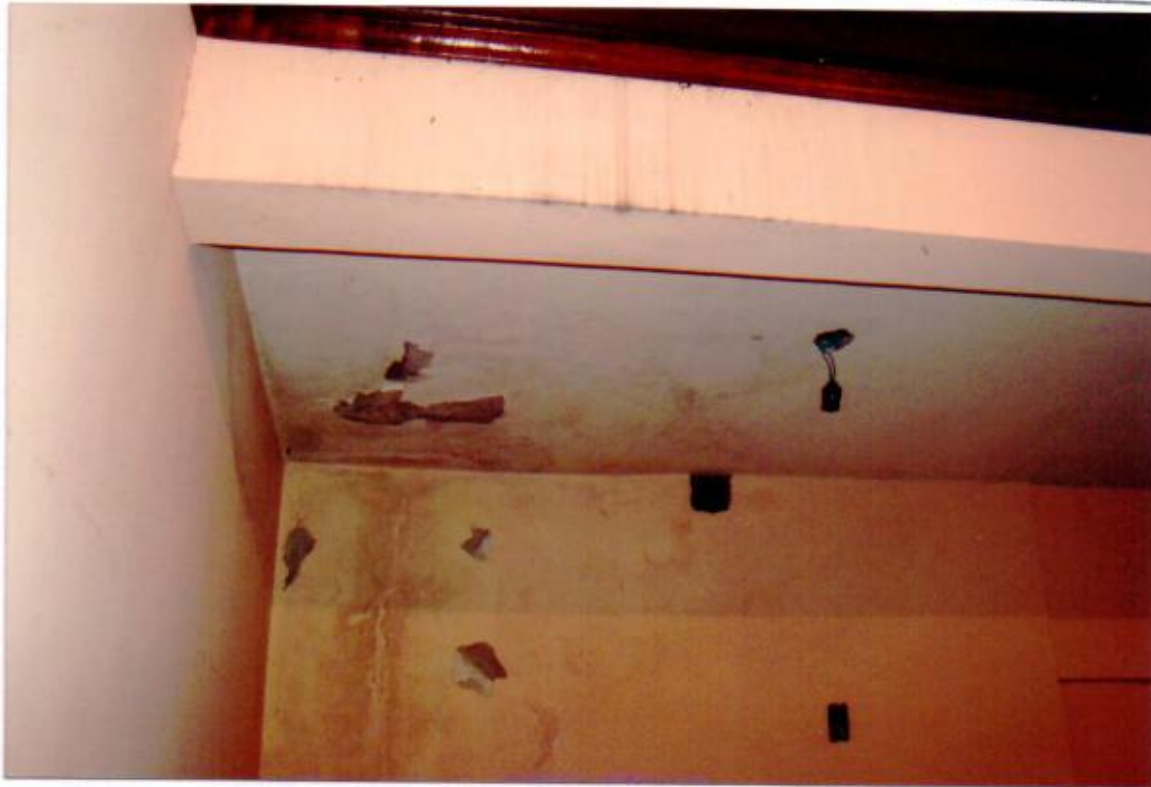
Presença de umidade decorrente da falta de proteção mecânica na cobertura da edificação. Observa-se a presença de elementos que levam a degradação dos rebocos em toda a Edificação
