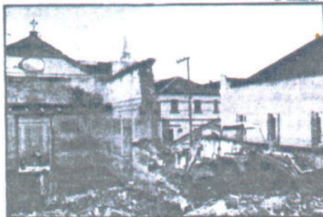
Máquina chegou a derrubar parte da parede lateral retirados hoje".
