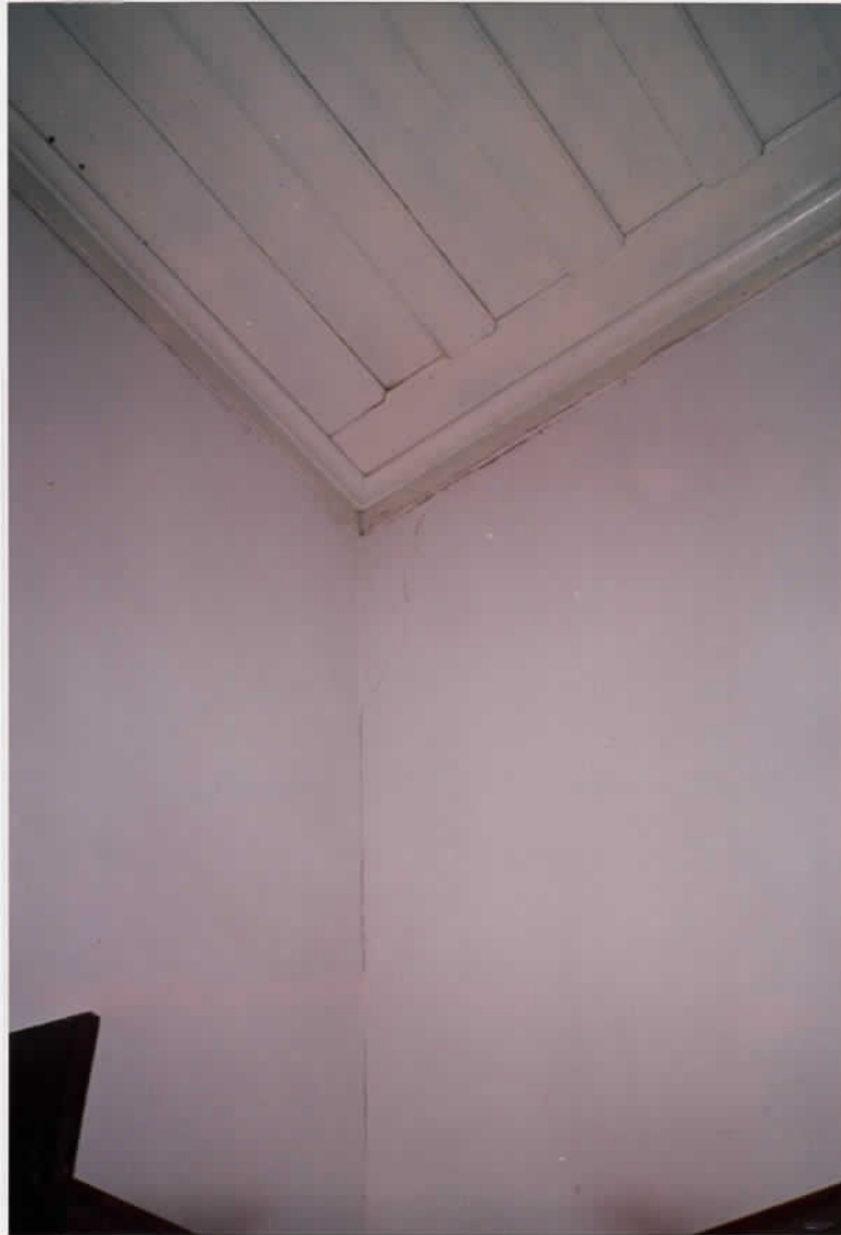
12 • RACHADURAS NA PAREDE
