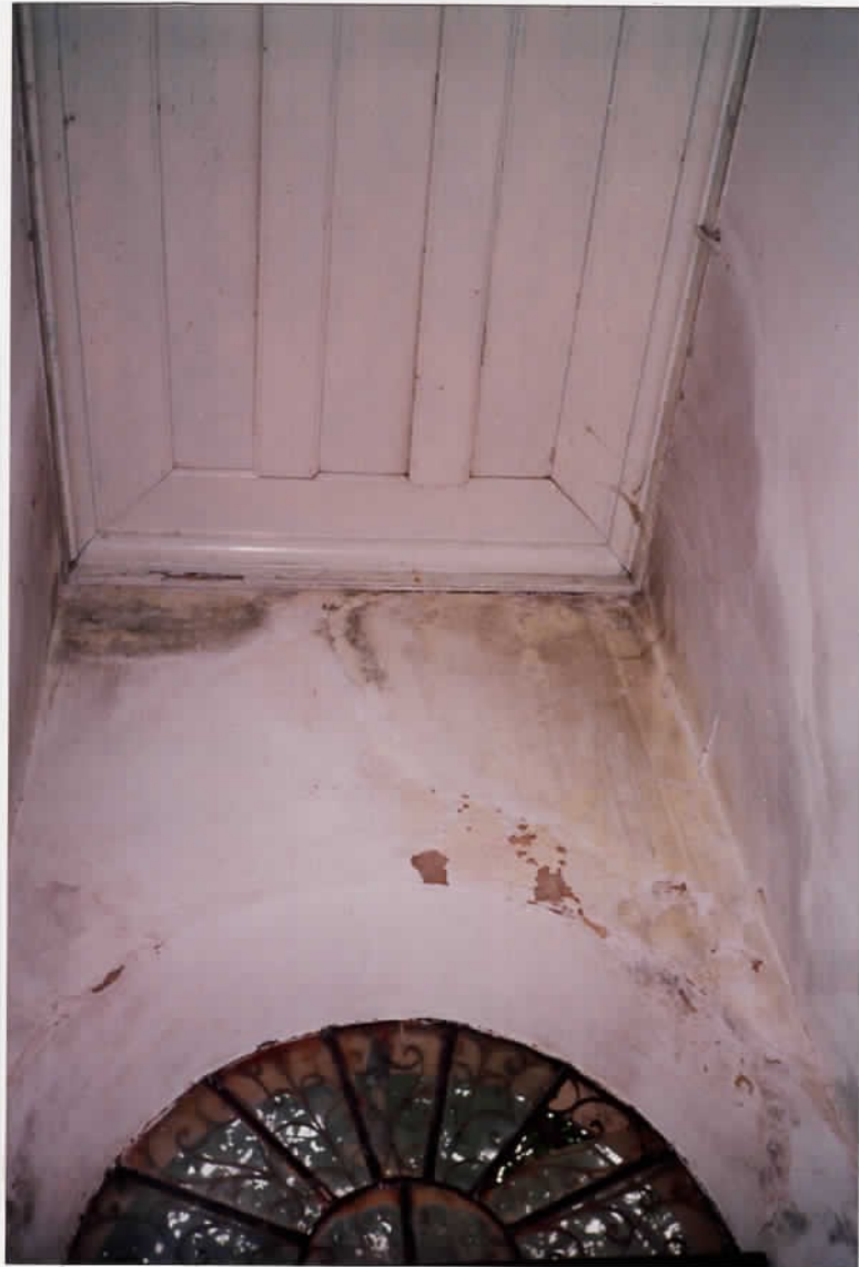
13 • VISTA INTERNA DA PAREDE SUL (DA FACHADA). INFILTRAÇÃO NAS PAREDES, PROVENIENTE DO TELHADO.
