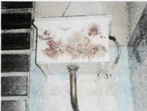
Foto 31- Detalhe da caixa de descarga
