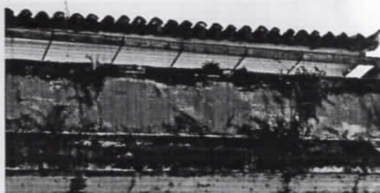
Vegetação incrustada nas rachaduras do prédio da Prefeitura Foto: Regina G. Buss
