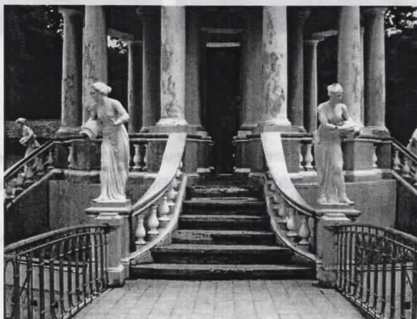
Colocação de pingadeiras e deterioração da pintura e do bocel Foto: Nelda Scheidt
