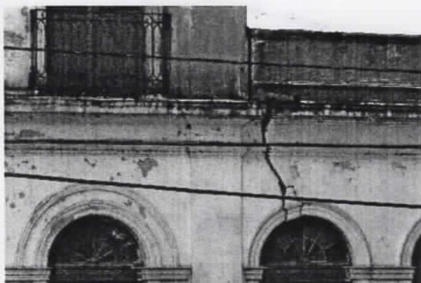
Rachadura no prédio da Prefeitura Municipal Foto: Regina G. Buss
