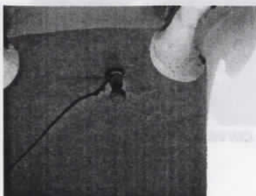
Instalações elétricas no teto do segundo piso Foto: Nelda Scheidt
