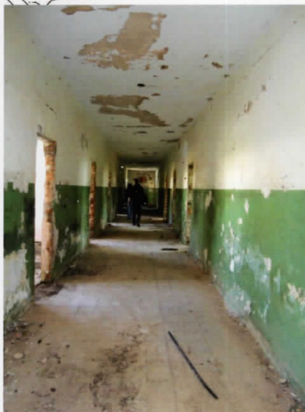
3 Interior do prédio depredado e abandonado
