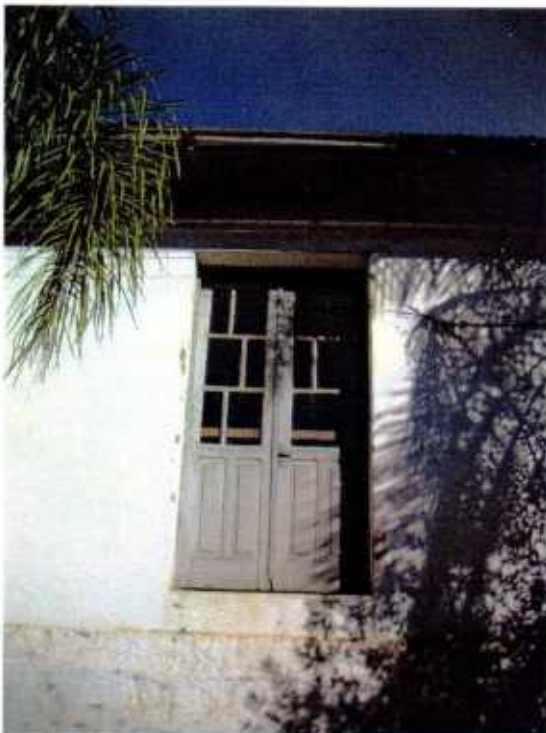
F08 Porta de acesso ao 2º Pavimento, pela Avenida Ipiranga.
