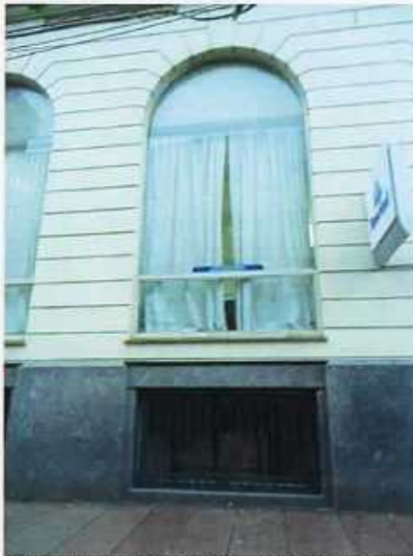
F22. Fachada Rua Andrade Neves – detalhe aberturas, grades no subsolo e modificações no térreo.
