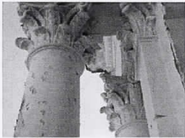
Pilares da fachada com pintura descascando
