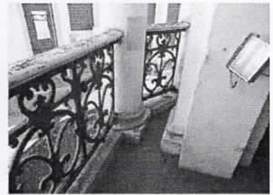
Guarda-corpo em metal deteriorado
