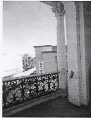
Sacada com piso em lajotas danificado
