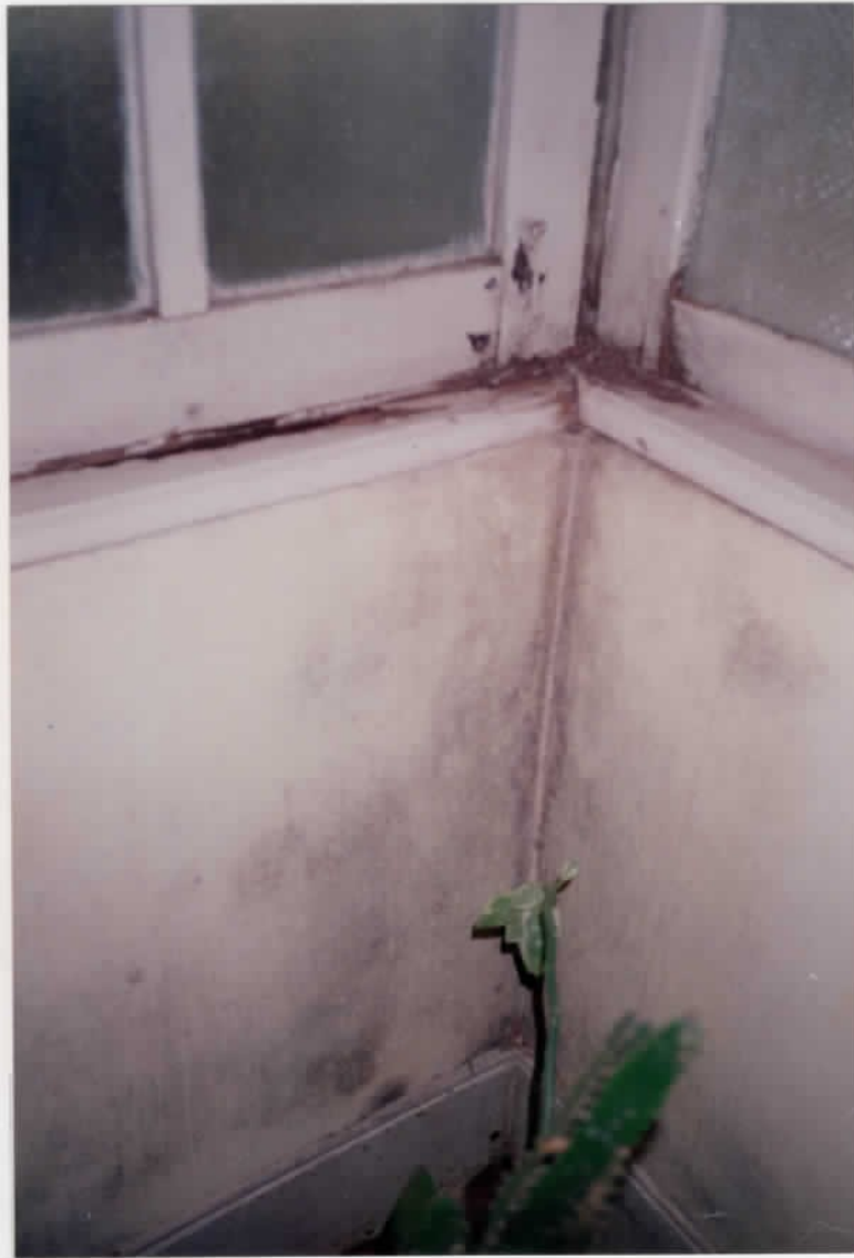
12 • DETALHE DA ESQUADRIA DE MADEIRA DA SALA DE JANTAR SOFRENDO AÇÃO DA UMIDADE.
