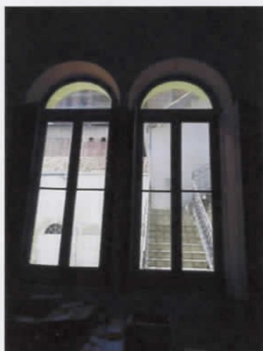
1 Janelas de duas folhas, em madeira, acabamento em tinta e bandeira fixa em arco pleno.
