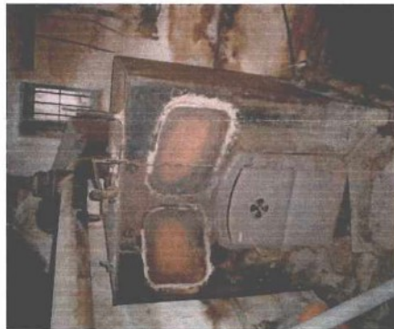
Figura 12. Corrosão e desgaste da caldeira do sistema de aquecimento do prédio.
