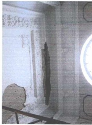
Figura 7. Apodrecimento do forro de estuque e descolamento do revestimento de gesso.
