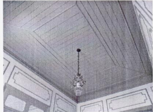
2 Pavimento Térreo - forro da Sala 2
