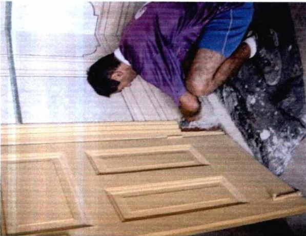
Figura 7. Reconposição de parte de uma esquadria de madeira.
