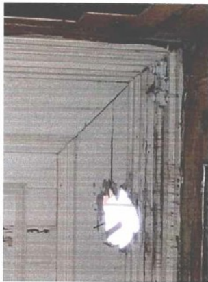
Figura 6. Apodrecimento do forro de madeira.
