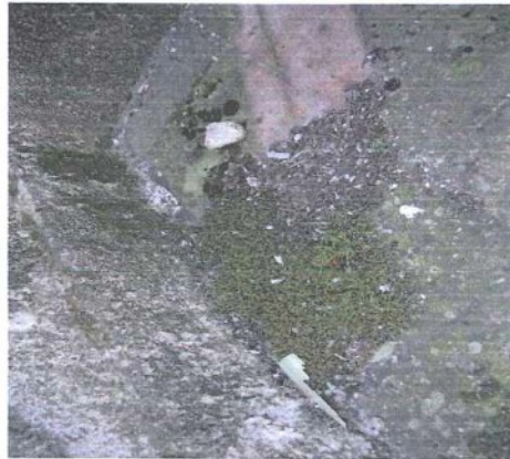
Figura 9. Acumulo de sujeira e presença de vegetação e fungos no piso do terraço.
