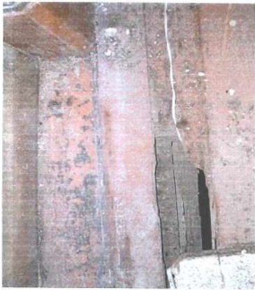
Figura 4. Apodrecimento do piso de madeira.
