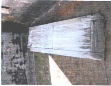
Figura 5. Apodrecimento da esquadria de madeira.
