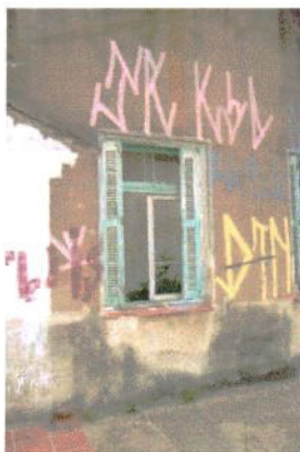
3 Prédio Principal - remanescente das esquadrias
