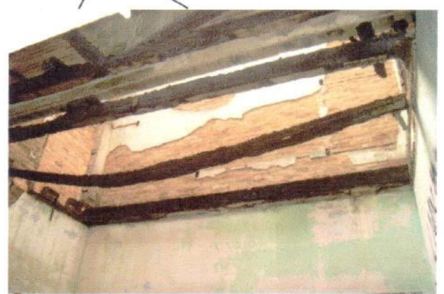
2 Estrutura de madeira carbonizada
