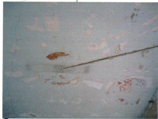
2 Capela - Forro danificado
