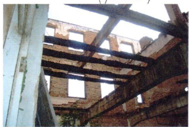
1 Vista interna: remanescentes da estrutura de entrespaço destruída por incêndio
