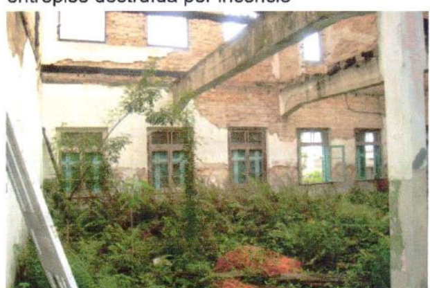
3 Vista interna das poucas esquadrias remanescentes
