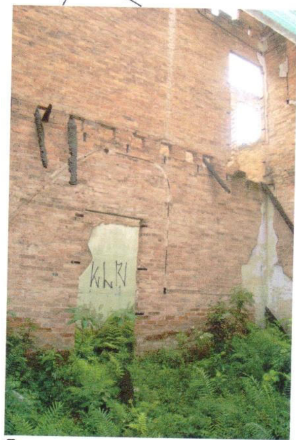
2 Prédio Principal - foto interna Remanescentes do barroejamento de madeira destruído por incêndio
