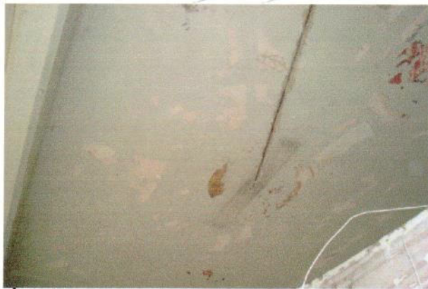
1 Capela - Forro danificado
